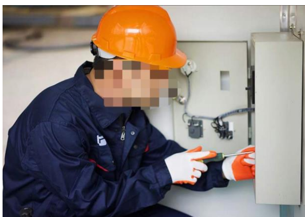
Figura 9 - Instalação Elétrica Protegida Fonte: Tem, 2018
