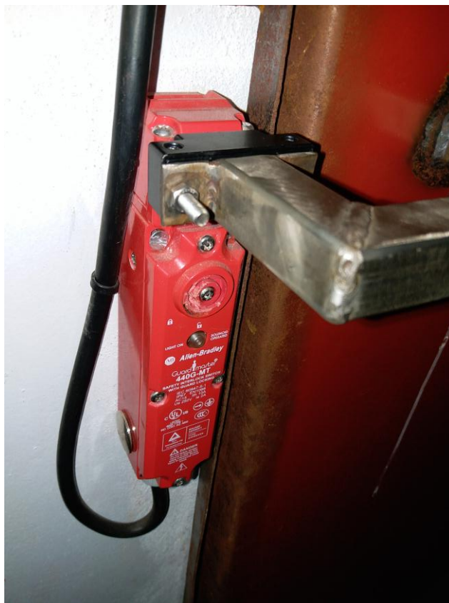
Fotografia 2 - Fechadura Eletromecânica Allen Bradley. Fonte: Autor (2018).
