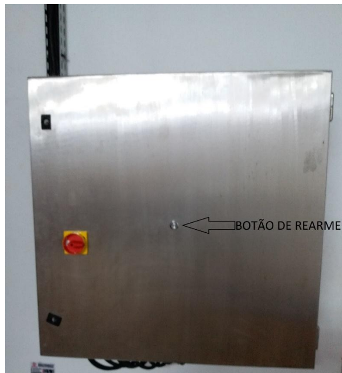
Fotografia 7 - Painel Elétrico. Fonte: Autor (2018).
