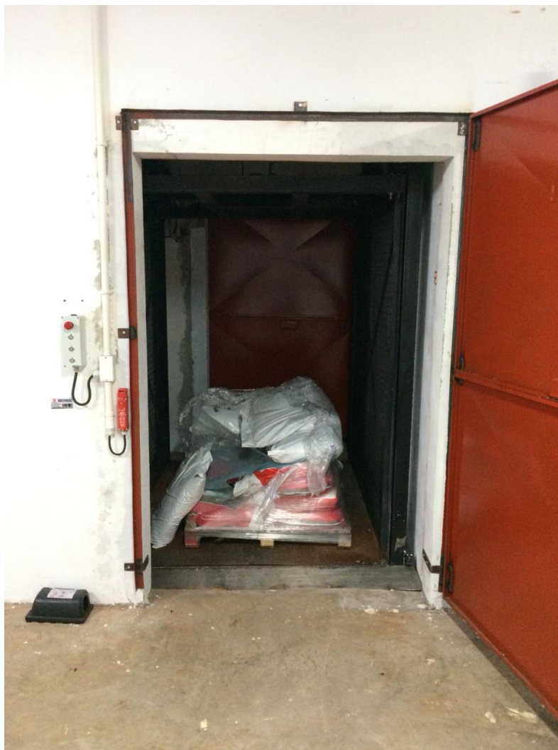
Fotografia 10 - Cabina do Elevador Fonte: Autor (2018).
