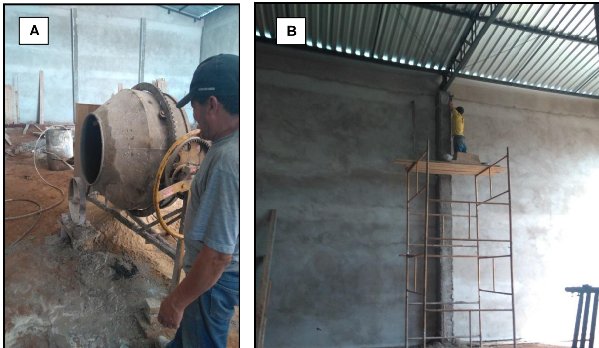
Fotografia 4 Funcionários sem uso de EPI e EPC's. Atividade com Betoneira (A) e Atividade em andaime (B).
