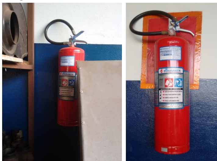
Fotografia 11: Extintores de incêndio
