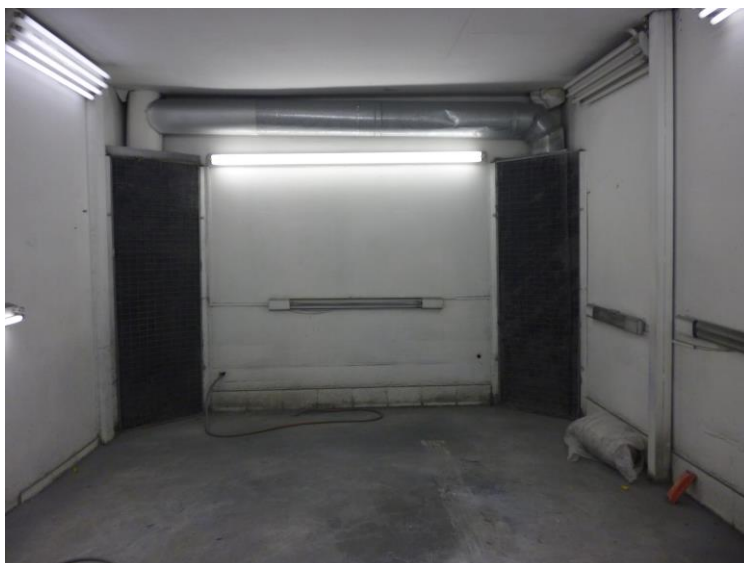
Fotografia 4: Cabine de pintura
