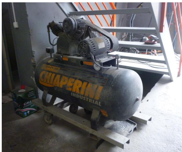
Fotografia 6: Compressor de ar
