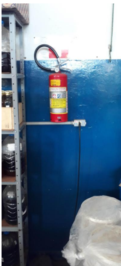
Imagem 1: Extintor obstruído e sem sinalização no chão. Fonte: Autoria própria
