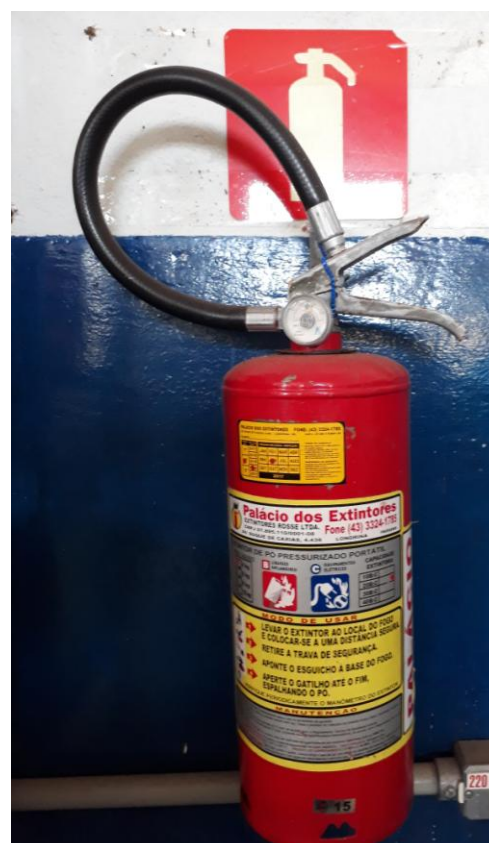
Imagem 2: Extintor com placa de sinalização. Fonte: Autoria própria
