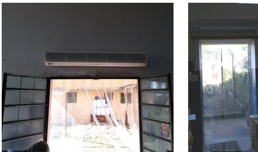
Imagem 3: Porta dos fundos e porta de entrada, sem placas de sinalização indicando saída Fonte: Autoria própria
