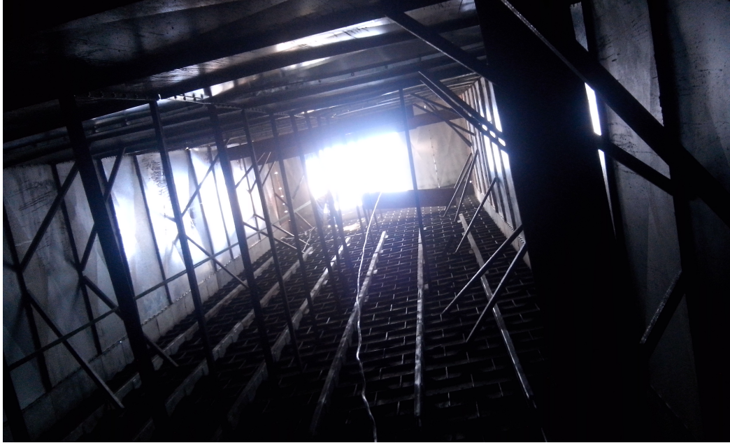
Figura 24 – Interior da plataforma Fonte: Autoria própria (2017)
