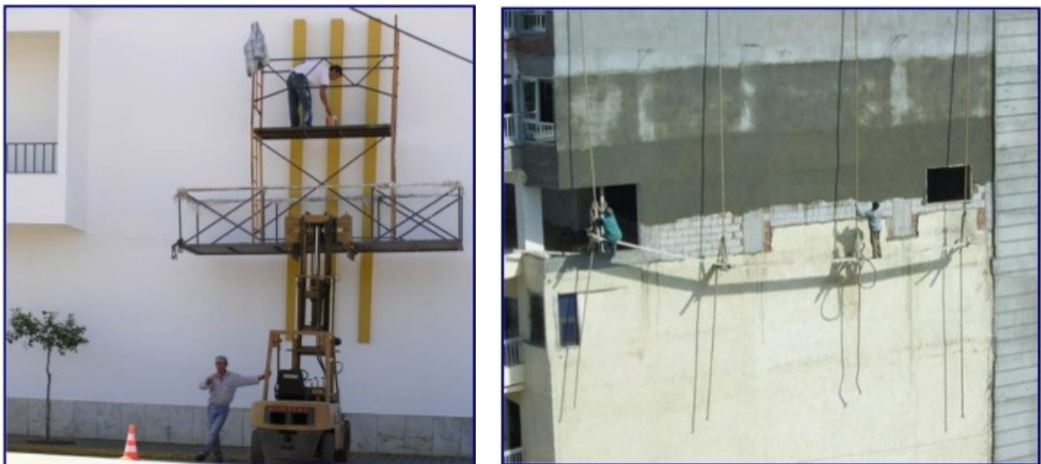
Figura 9 – Trabalho em altura sem EPI's Fonte: Boss (2013, p. 29-30)
