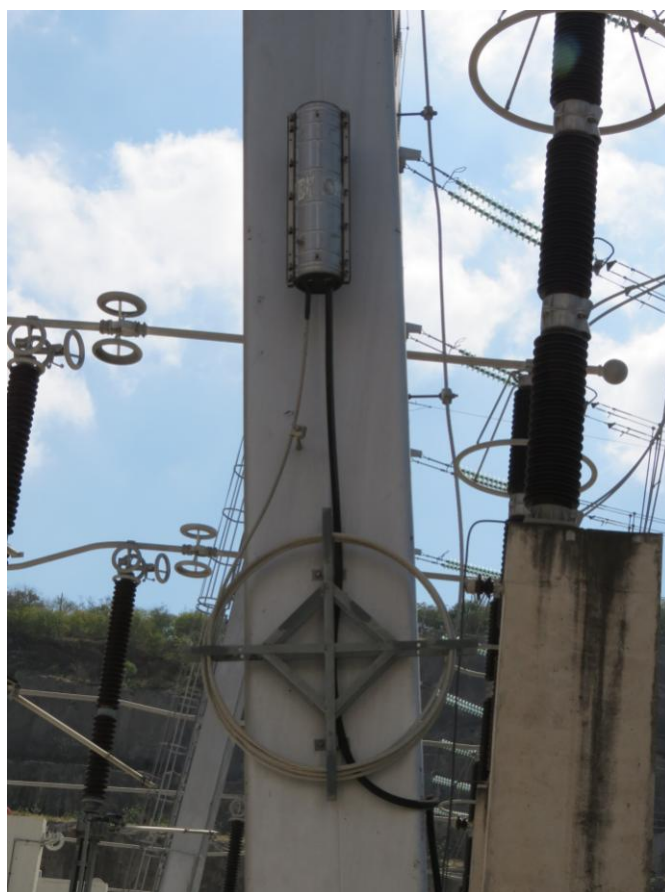
Figura 2 – Detalhe da ferragem de chegada de cabo OPGW e CEO Fonte: Autoria própria.
