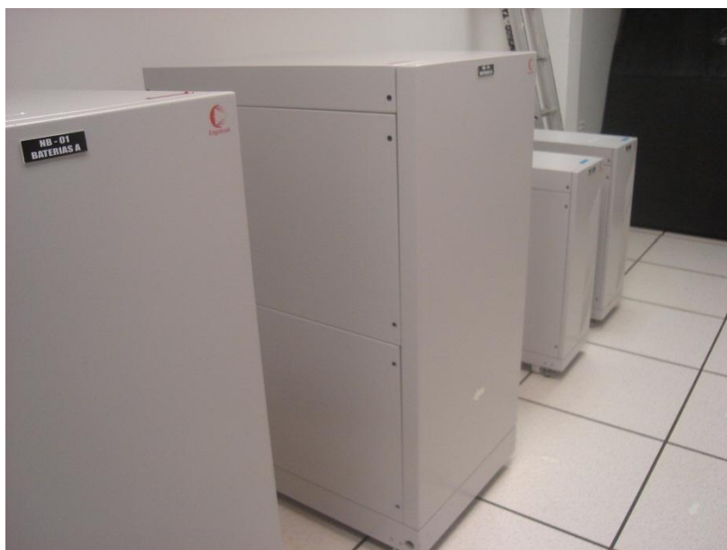
Figura 12 - Sistema de fornecimento ininterrupto de energia (UPS)
