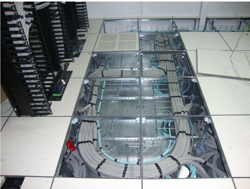
Figura 17 - Cabos dispostos sob o piso elevado
