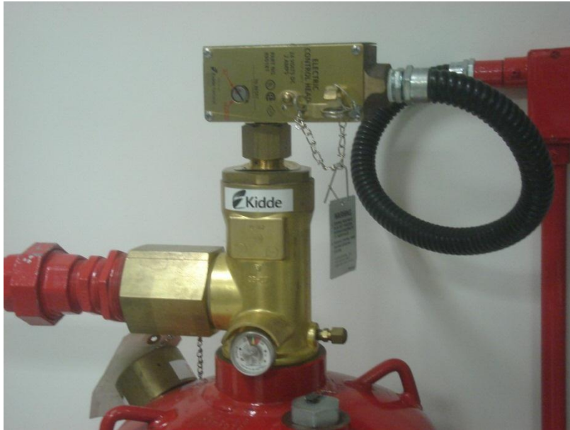
Figura 14 - Sistema de prevenção e combate a incêndios
