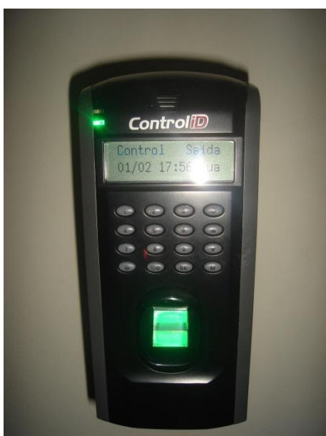
Figura 13 - Sistema de controle de acesso biométrico
