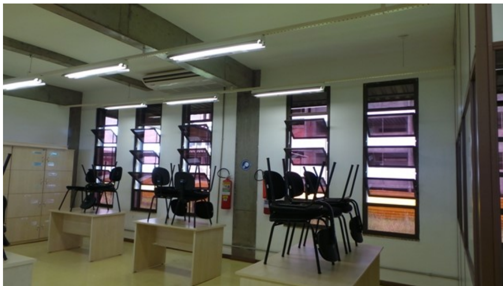
Figura 36 – Fotografia – distribuição das luminárias – Biblioteca de Londrina Fonte: Autoria própria
