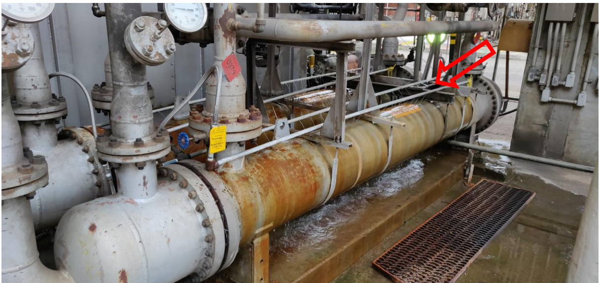
Figura 26 - Sistema de aspersão de água instalado sobre o trocador de calor
