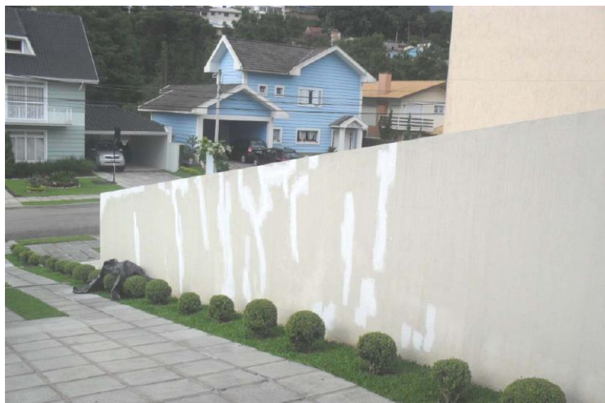
FIGURA 24 – FISSURAS NO MURO FRONTAL Fonte: AUTOR, (2016)
