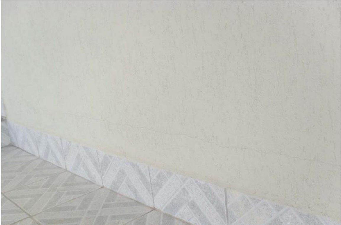
FIGURA 21 – TRINCA 7 NA GARAGEM Fonte: AUTOR, (2016)
