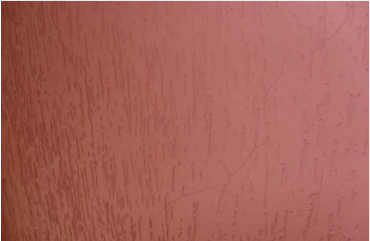
FIGURA 19 – TRINCA 5 NA PAREDE DO CLOSET Fonte: AUTOR, (2016)
