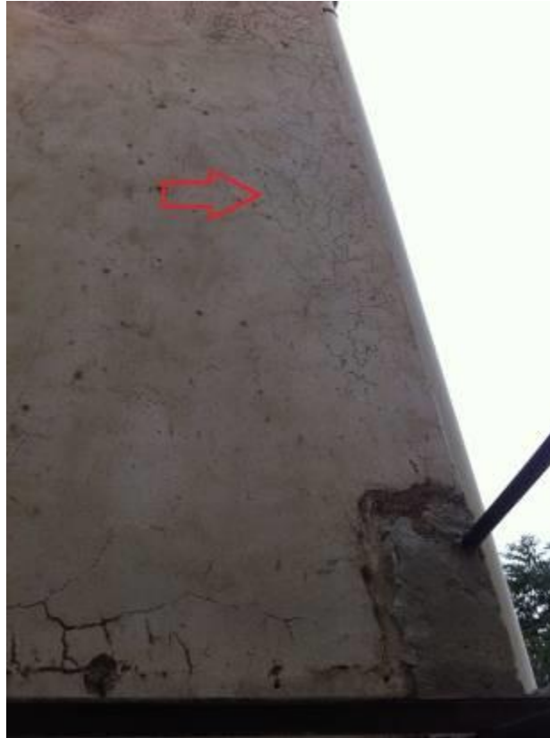
FIGURA 4 – FISSURAÇÃO TÍPICA NA ARGAMASSA POR MOVIMENTAÇÃO TÉRMICA Fonte: Autor, (2016)
