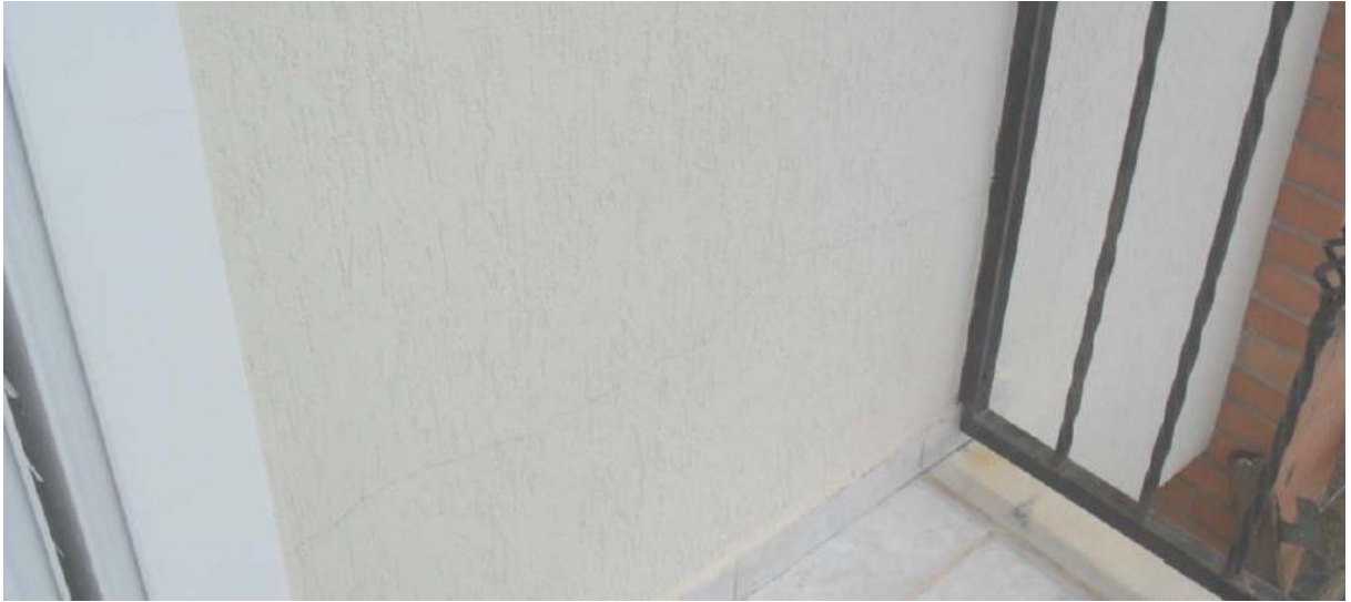
FIGURA 16 – TRINCA 2 DO LADO DIREITO DE QUEM DA RUA OBSERVA Fonte: AUTOR, (2016)
