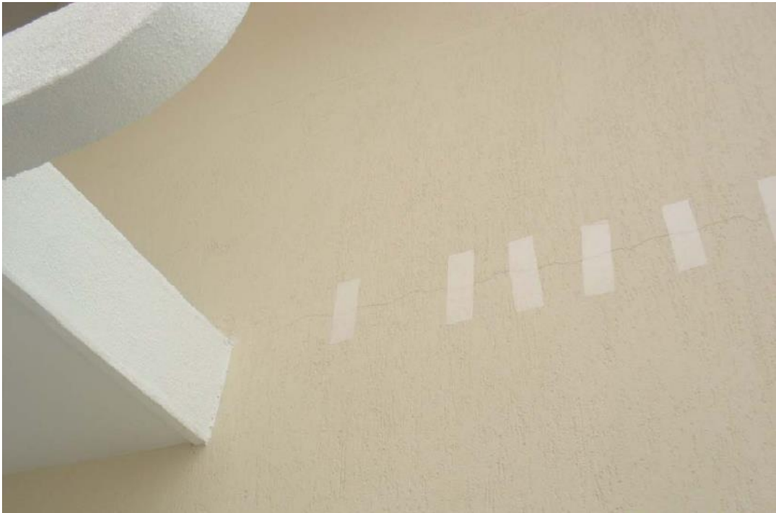
FIGURA 17 – TRINCA 3 NA LATERAL ESQUERDA DA EDIFICAÇÃO Fonte: AUTOR, (2016)
