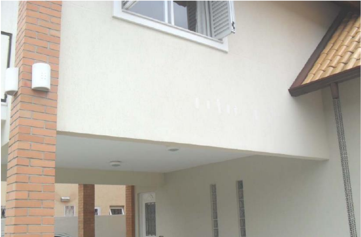
FIGURA 18 – TRINCA 4 NA LATERAL DIREIRA DA EDIFICAÇÃO Fonte: AUTOR, (2016)
