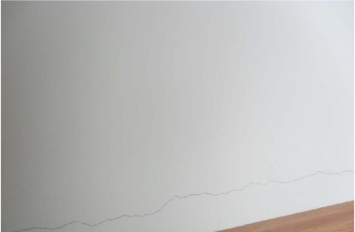
FIGURA 20 – TRINCA 6 SOBRE O RODA PÉ Fonte: AUTOR, (2016)
