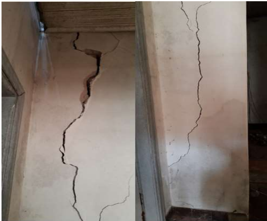
Figura 7: Danos estruturais em edificação unifamiliar, causa: recalque diferencial.
