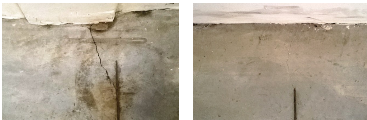
Figura 31 – Ausência de trecho final de juntas serradas, originando fissura na continuidade das juntas Fonte: autoria própria (2016)
