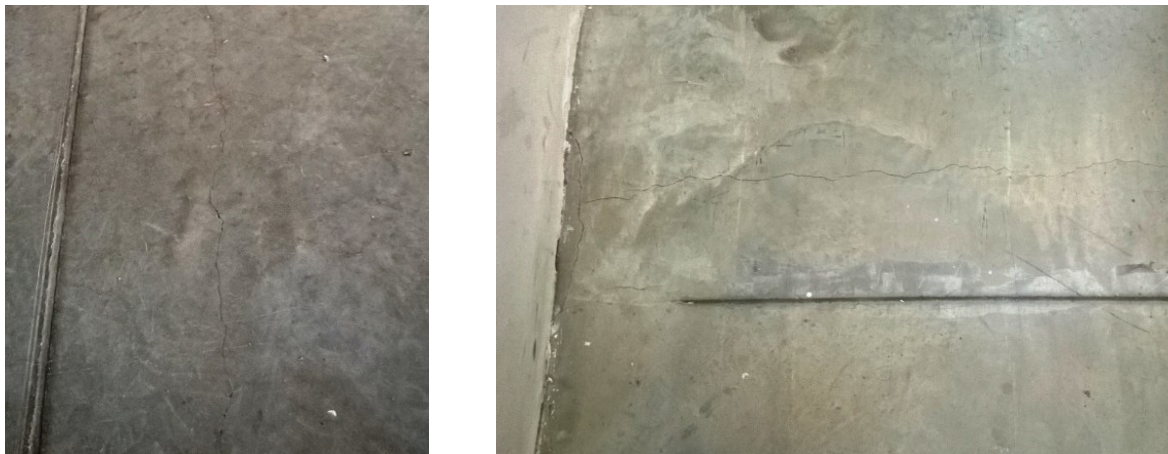
Figura 28 – Fissuras de retração por secagem (transversais ou longitudinais), na proximidade das juntas Fonte: autoria própria (2016)
