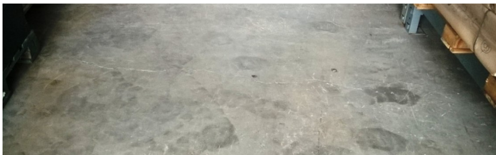
Figura 24 – Fissura linear transversal em placa; desgaste por abrasão Fonte: autoria própria (2016)
