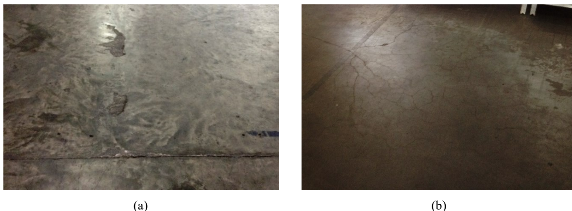
Figura 34 – Esborcinamento de junta, desgaste por abrasão e delaminação (a); microfissuras tipo “pé-de-galinha”, desgaste por abrasão e delaminação (b) Fonte: Gerência de Engenharia dos Correios do Paraná (2015)
