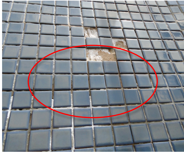
Figura 20 - Falha de rejunte em fachada de revestimento cor escura
