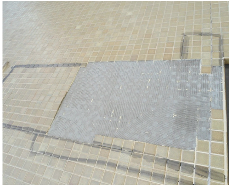
Figura 23 - Argamassa colante em fachada de revestimento cor clara
