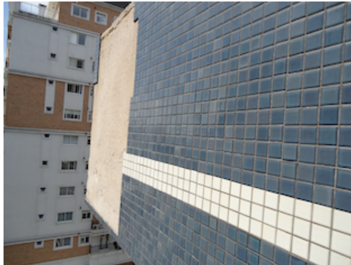
Figura 12 - Deslocamento de revestimento cor escura
