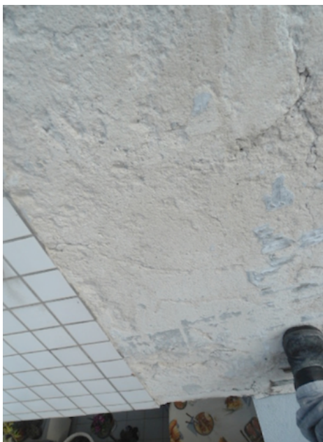
Figura 14 - Desplacamento de revestimento cor clara
