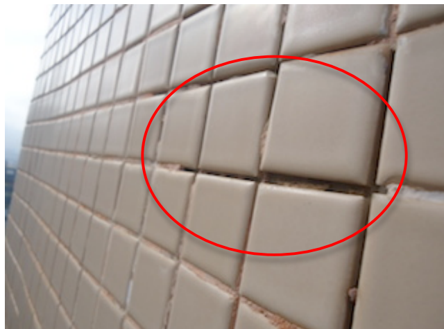
Figura 21 - Falha de rejunte em fachada de revestimento com cor clara
