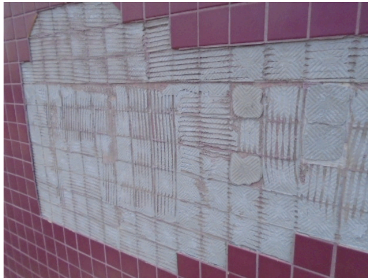
Figura 24 - Argamassa colante em fachada de revestimento cor escura
