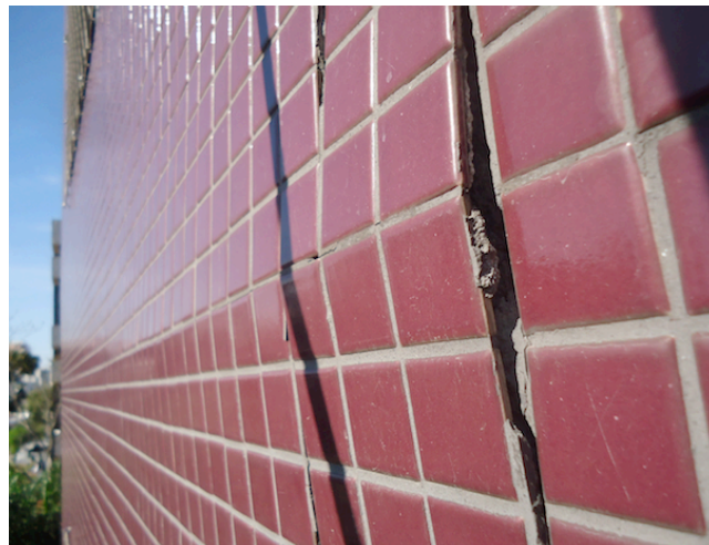
Figura 13 - Estufamento de revestimento cor escura
