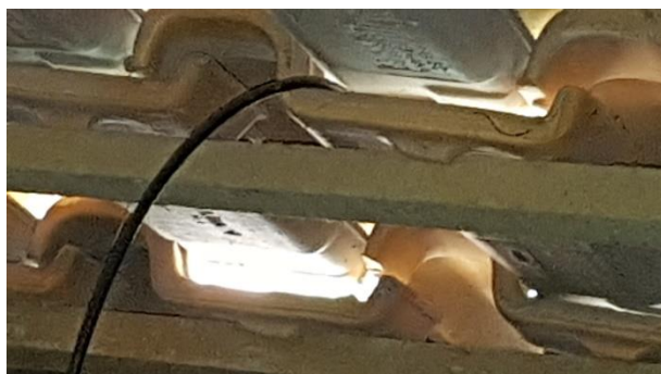
Figura 11 – encaixe deficiente Fonte: autor
