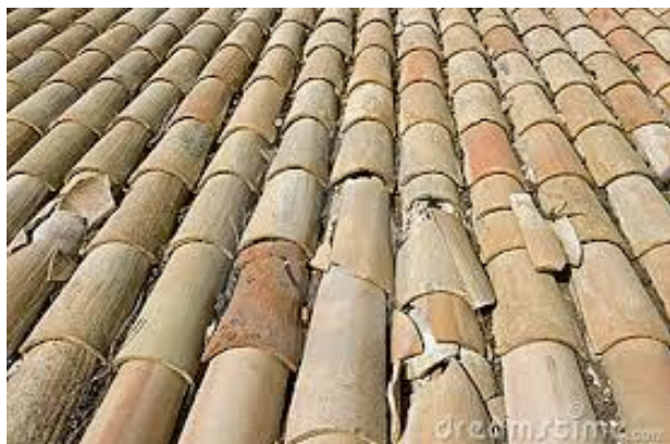
Figura 13 – telhas cerâmicas quebradas Fonte: www.pt.dramstime.com
