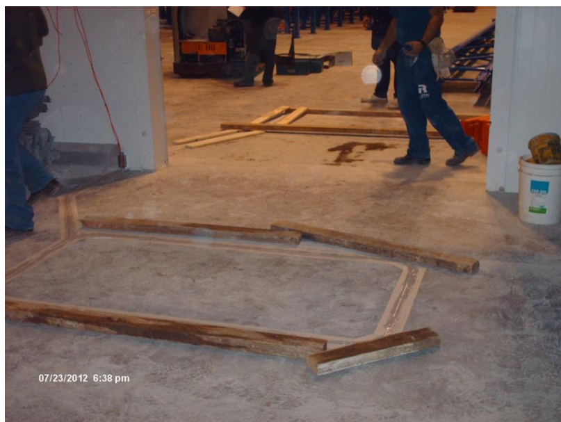
FIGURA 19 – PREPARO SENSORES DE ABERTURA PORTAS
