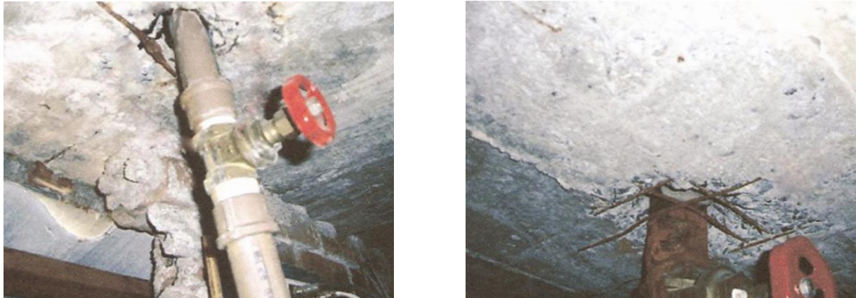
Figura 4.28 - 4.29 – Ausência de flange e armaduras expostas – Bloco C. Fonte: Acervo pessoal (2014).
