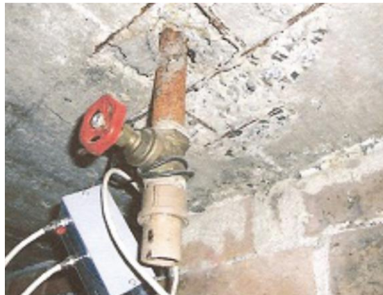
Figura 4.21 – Ladrão cortado e armaduras expostas – Bloco A. Fonte: Acervo pessoal (2014).
