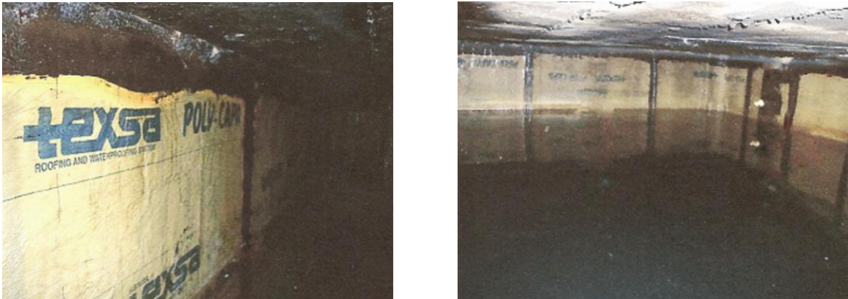
Figura 4.1 – 4.2 – Manta asfáltica deteriorada – Bloco A. Fonte: Acervo pessoal (2014).
