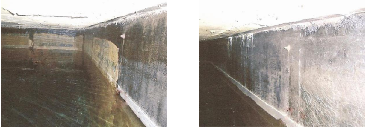
Figura 4.6 - 4.7 – Manta asfáltica deteriorada – Bloco C.
