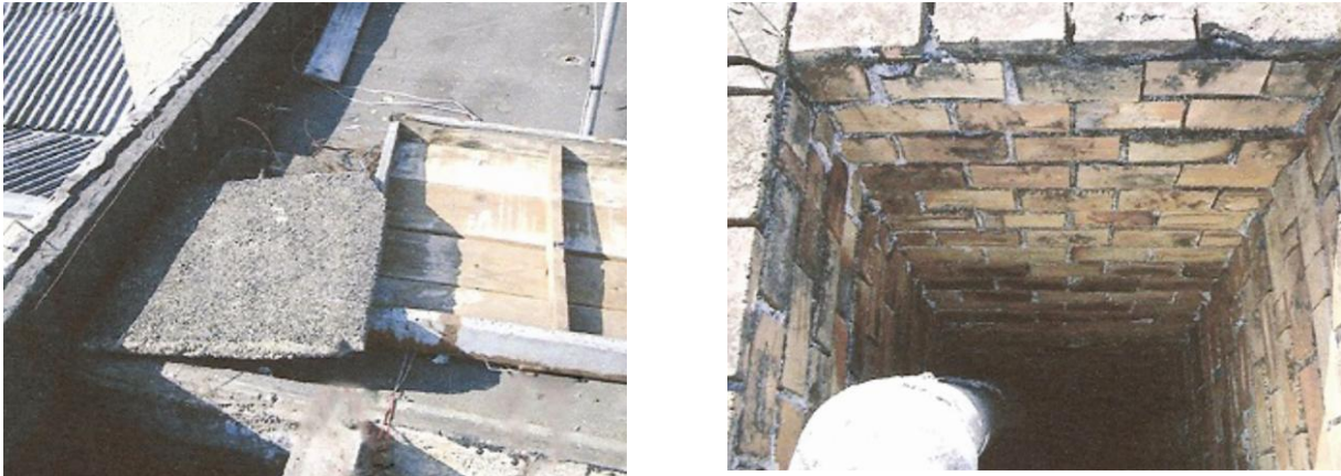
Figura 4.15 – 4.16 – Tampas inadequadas e duto de lixo – Bloco - B. Fonte: Acervo pessoal (2014).
