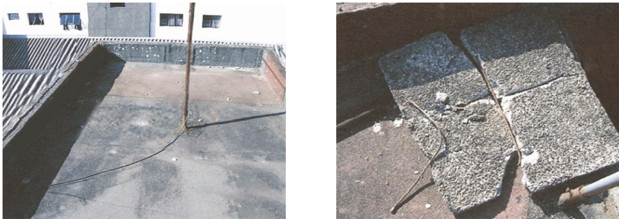
Figura 4.17 - 4.18 – Laje de cobertura e tampas em pedaços – Bloco C. Fonte: Acervo pessoal (2014).
