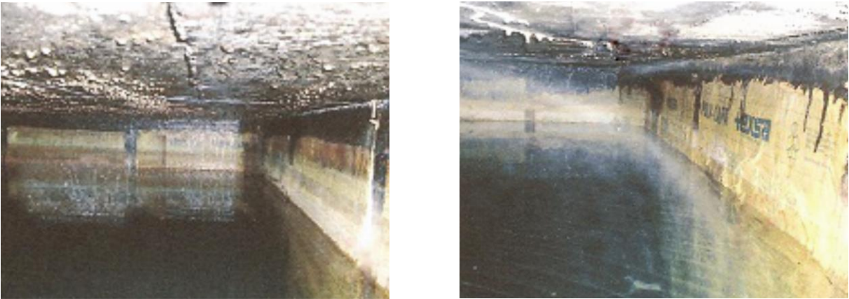
Figura 4.3 – 4.4 – Manta asfáltica deteriorada e infiltrações.- Bloco B Fonte: Acervo pessoal (2014).
