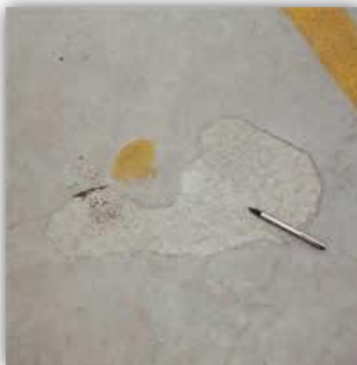
Fig. 64 - Aspecto delaminação (Fonte: SUPRENANT E MALISCH, 1998)
