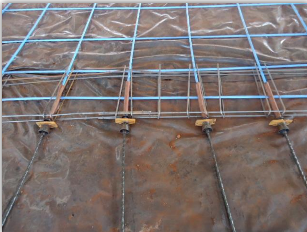
Fig. 43 – Montagem do conjunto de ancoragem com o cabo passando do limite da forma para protensão (Fonte: Própria)
