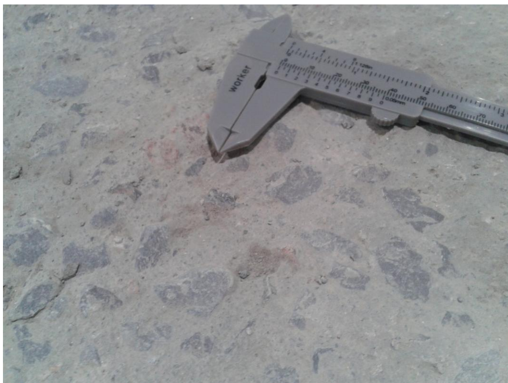
Fig. 85 – Detalhe de separação da camada mais profunda com agregado graúdo aderido ao piso base (Fonte: Própria)
