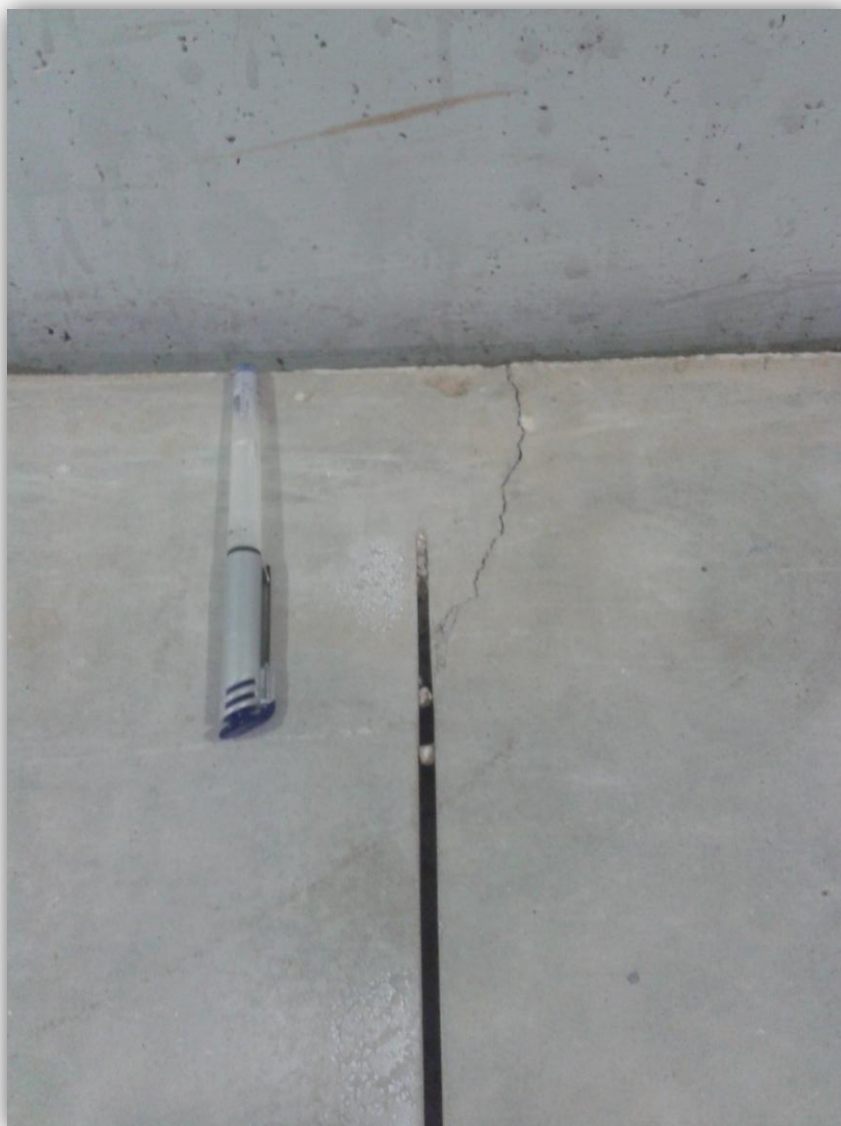
Fig .62 – Fissuração fora da área de controle provocada por corte terminando muito afastado da junta de encontro (Fonte: Própria)
