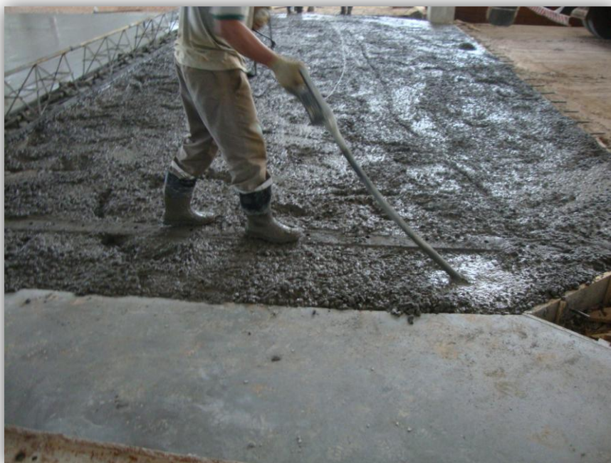
Fig. 56 – Execução de piso com régua vibratória treliçada e vibradores de imersão (Fonte: Própria)
