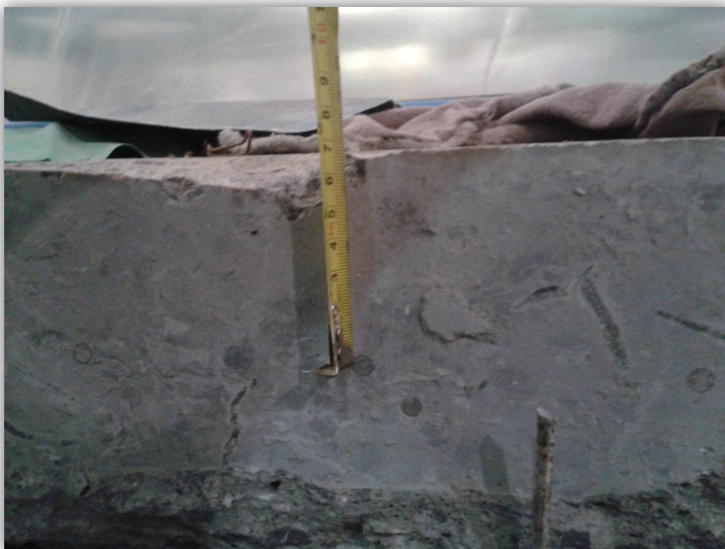
Fig. 41 – Exumação de piso com armadura superior rebaixada, praticamente colada com armadura inferior (Fonte: Própria)
