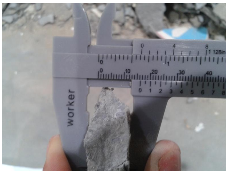
Fig. 82 – Detalhe da porção mais profunda delaminada (Fonte: Própria)
