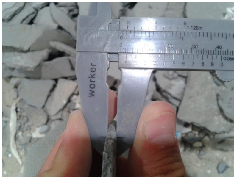
Fig. 81 – Detalhe da porção mais superficial delaminada (Fonte: Própria)
