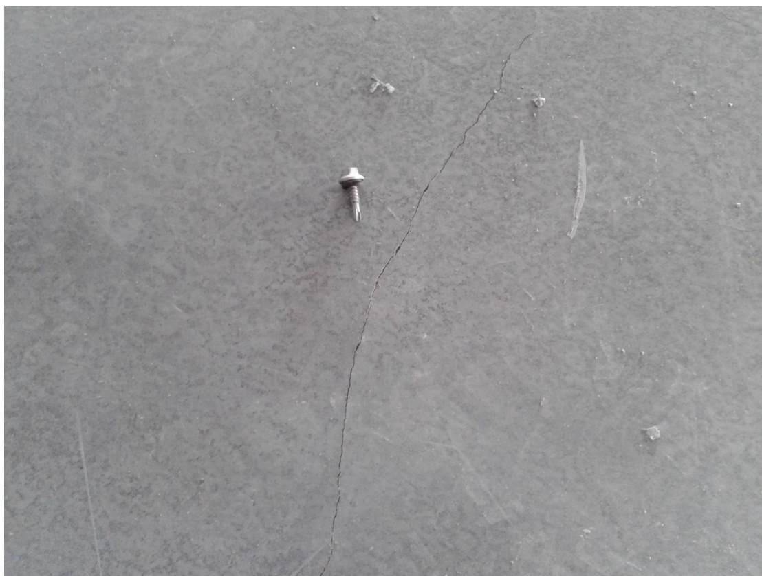
Fig. 75 – Primeira fissuras no piso já acabado (Fonte: Própria)
