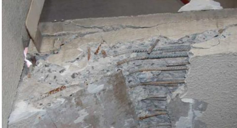
Figura 38: Falhas causadas por execução diferente do projeto. Fonte: Videla, 2012.
