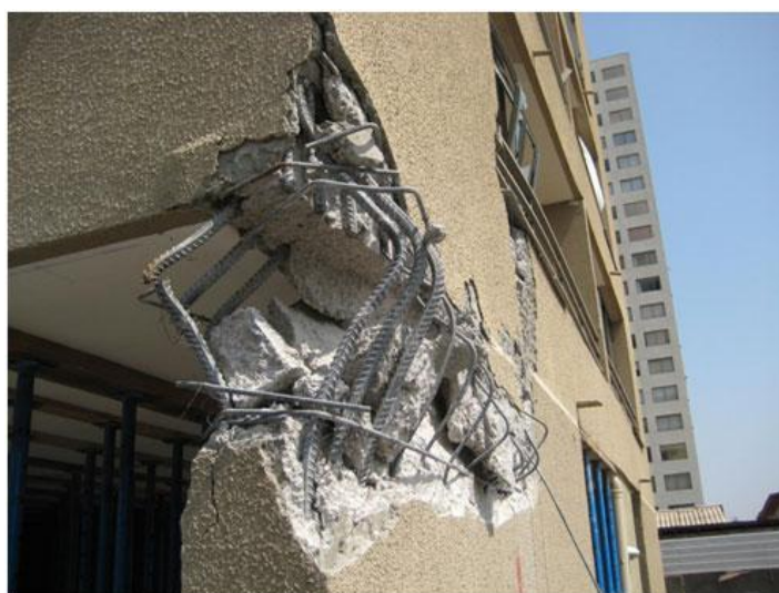
Figura 30: Danos causados ao pilar-parede por abalo sísmico
