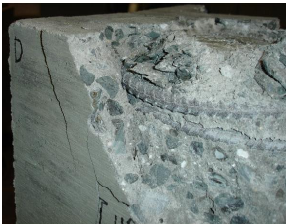
Figura 28: Concreto esmagado abaixo da placa de ancoragem Fonte: Axson, 2008.
