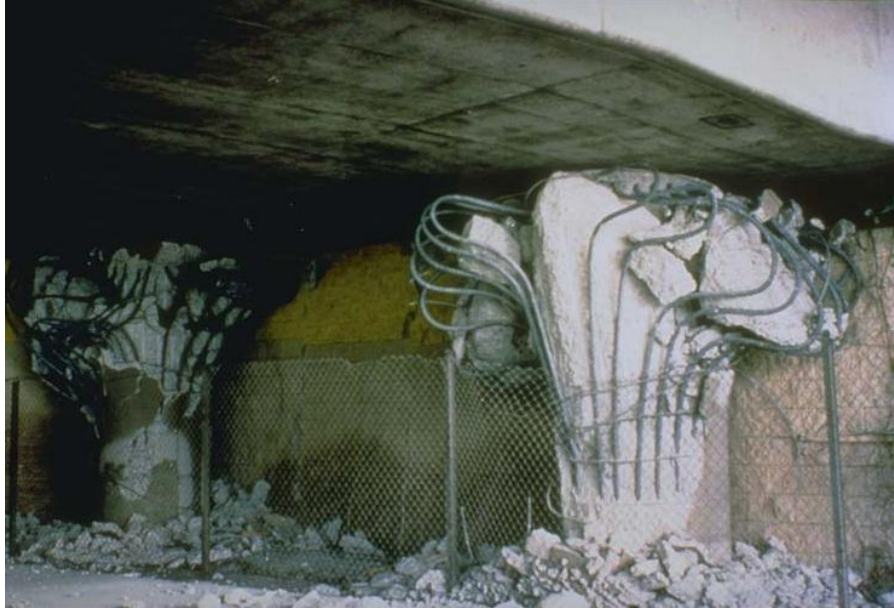
Figura 31: Danos causados aos pilares do Viaduto de Northidge na Califórnia pelo terremoto de 1994 Fonte: http://www.smate.wvu.edu/teched/geology/eq-columns.html .
