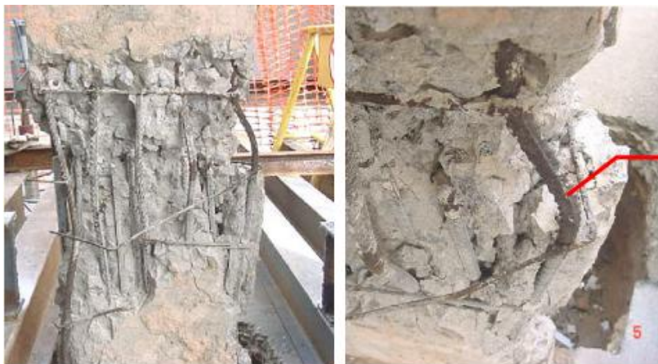
Figura 33: Flambagem das barras longitudinais entre os estribos Fonte: Thomaz, 2014.
