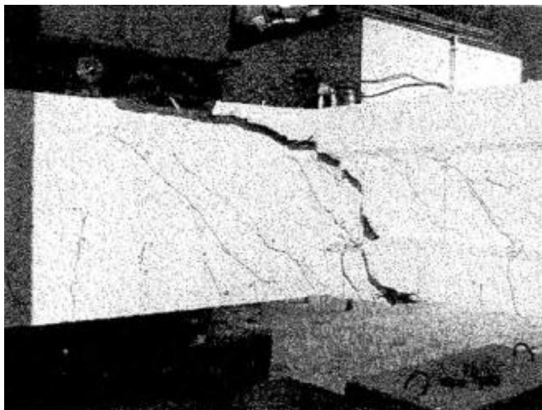
Figura 23: Ruptura na região de apoio indireto entre vigas Fonte: Ribeiro, 2001.
