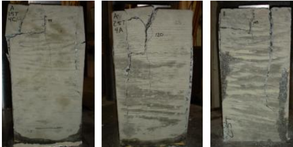
Figura 25: Configurações das fissuras nos prismas reforçados com estribos retangulares Fonte: Axson, 2008.
