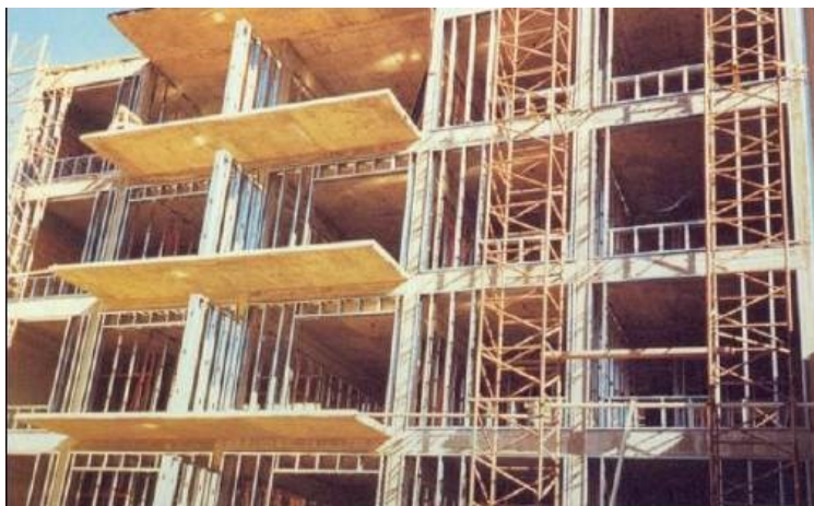
Figura 4 – Fechamento em LSF, método embutido, em estrutura de concreto armado Edifício residencial San Nicolás, Argentina.
