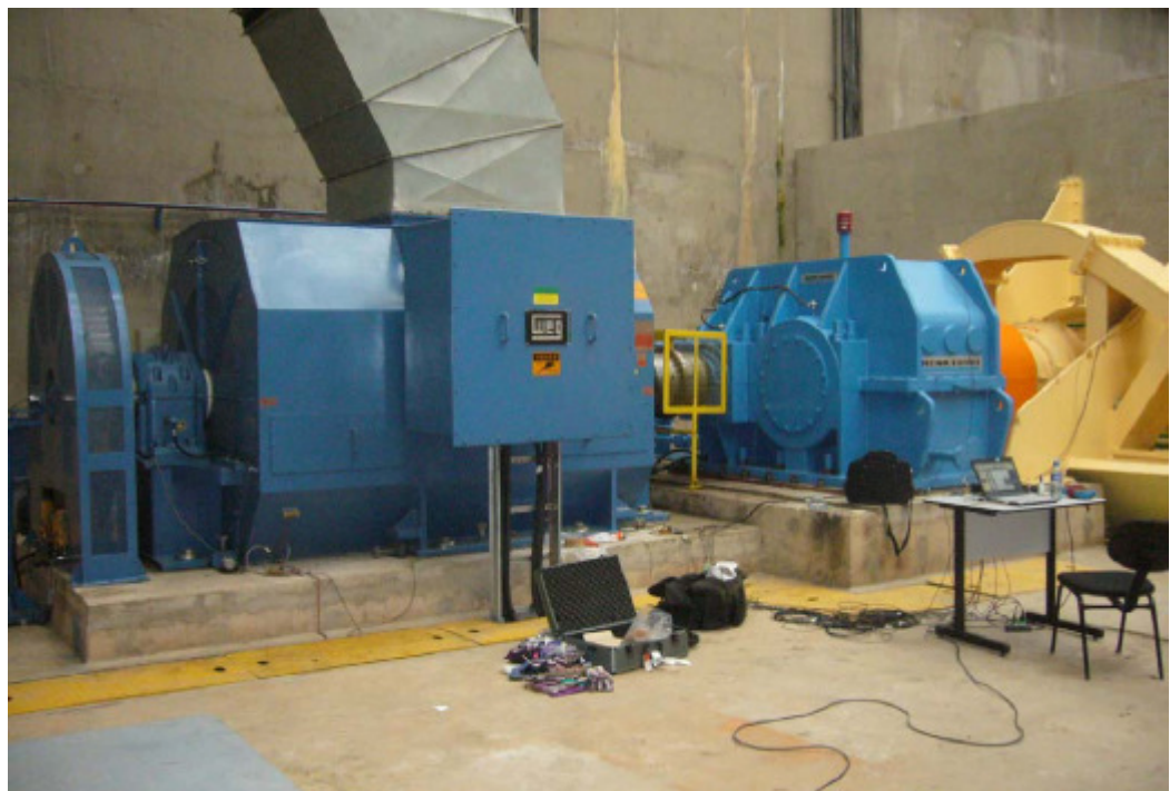
Figura 3 – Monitoramento de vibrações Fonte: empresa estudada, 2011.
