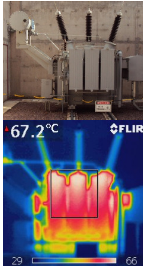
Figura 6 – Termografia – Transformador 13,8kV/138kV Fonte: Empresa estudada, 2011.
