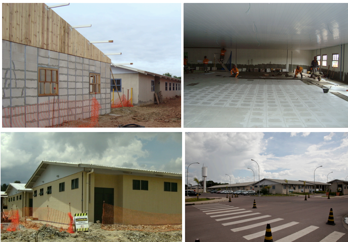
Figura 3: Canteiro de obras sendo construído em alvenaria de blocos de concreto celular estruturados com perfis metálicos. Fonte: A autora, 2009.
