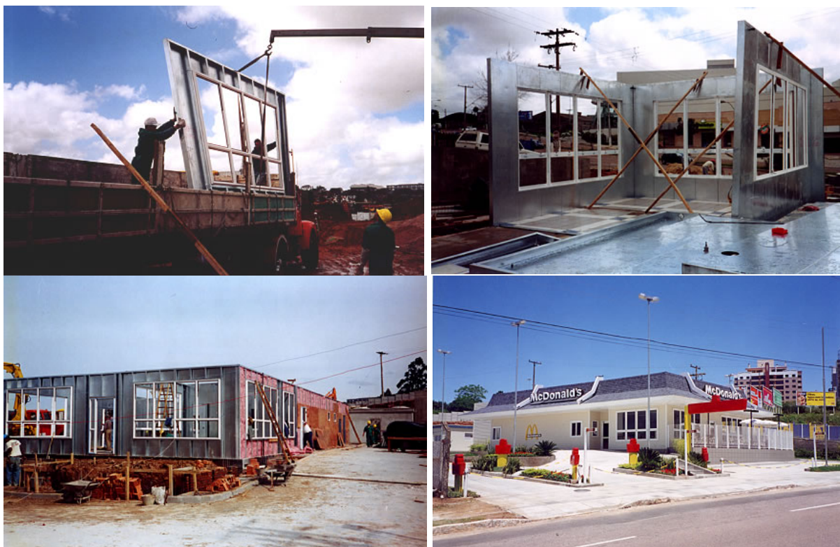
Figura 14: Loja da rede McDonalds construída com o sistema Quick House. Fonte: Quick House (QUICKHOUSE, 2014).
