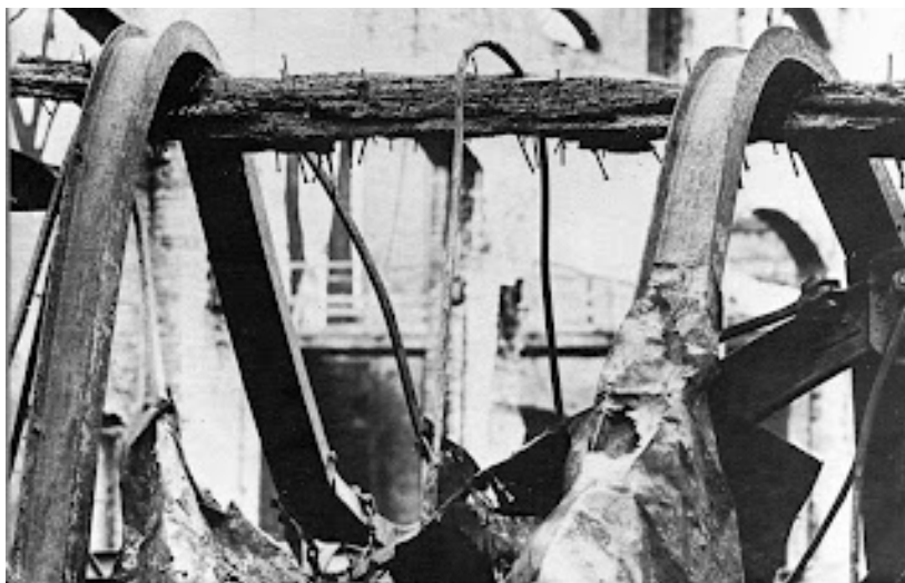
Figura 1: Após um incêndio as vigas de aço se deformaram completamente, enquanto a de madeira ainda consegue suportar sua própria carga. (Fonte: http://estruturasdemadeira.blogspot.com.br )
