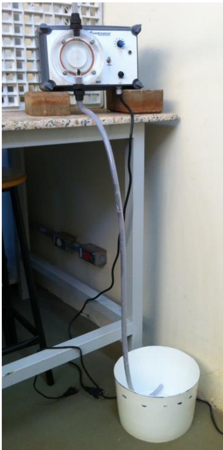
Figura 19 - Fotografia da bomba dosadora de alimentação da água residuária Fonte: Autoria própria.
