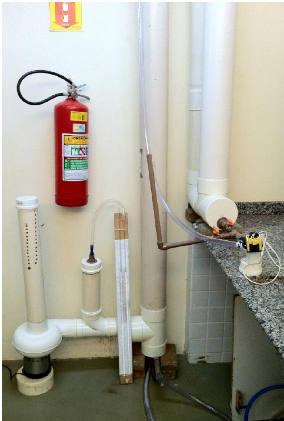
Figura 16 - Fotografia da torre de air stripping e dispositivos, vista da parte inferior do módulo
