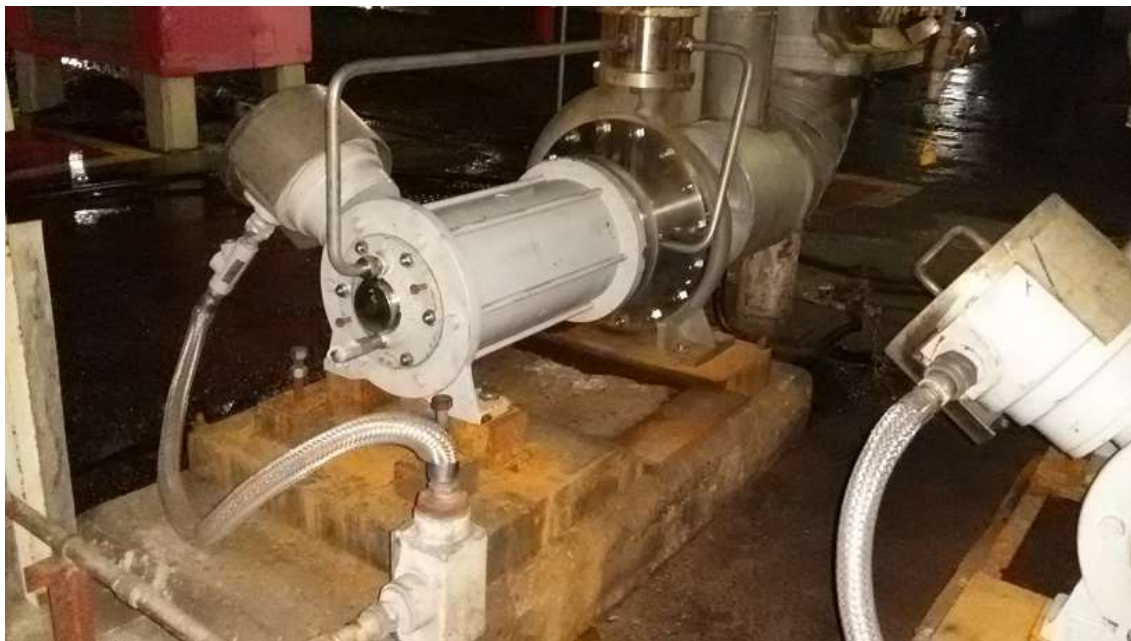
Figura 2.1 Vista da bomba com a tubulação de balanço e arrefecimento do motor
