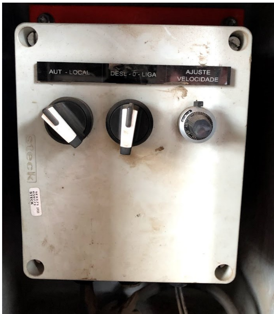
Figura 7 – Caixa de comando local de balança dosadora
