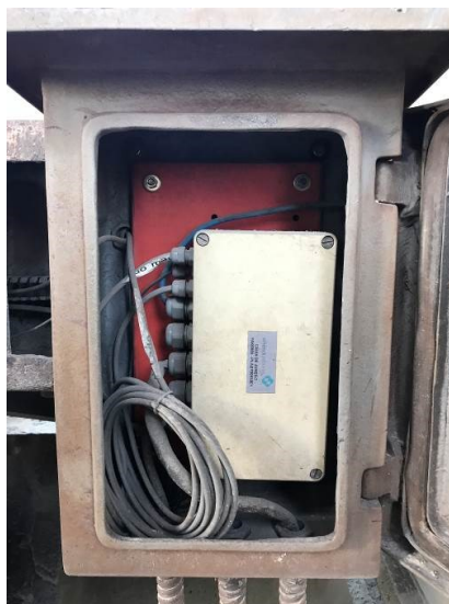
Figura 2.6 – Caixa de passagem de balança dosadora
