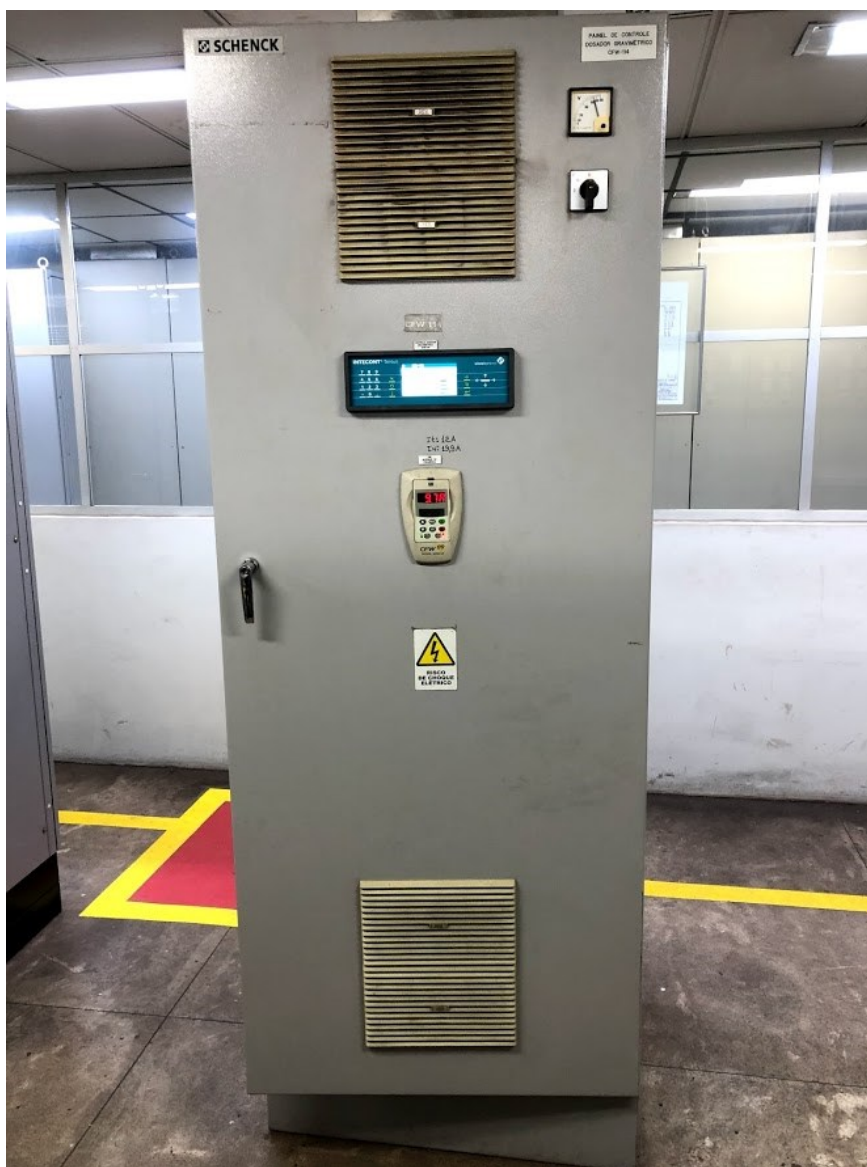
Figura 2.13 – Painel elétrico de uma balança dosadora
