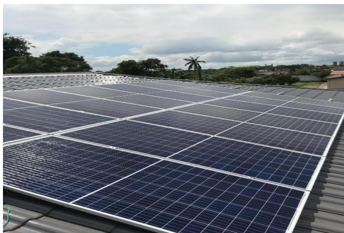
Figura 14 - Sistema Fotovoltaico "planta 1"
