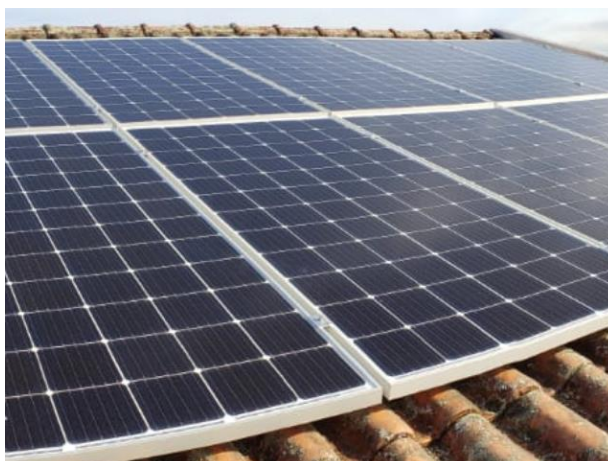
Figura 20 - Sistema Fotovoltaico "planta 4"
