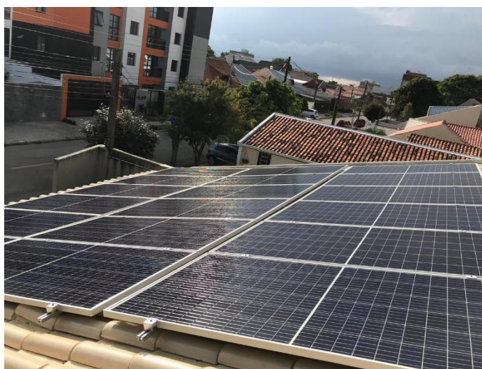
Figura 16 - Sistema Fotovoltaico "planta 2"
