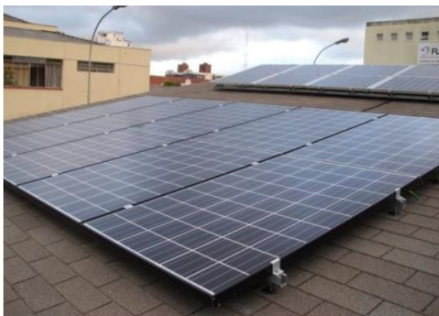
Figura 22 - Sistema Fotovoltaico "planta 5"
