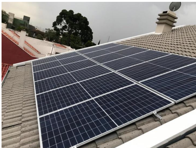
Figura 18 - Sistema Fotovoltaico "planta 3"
