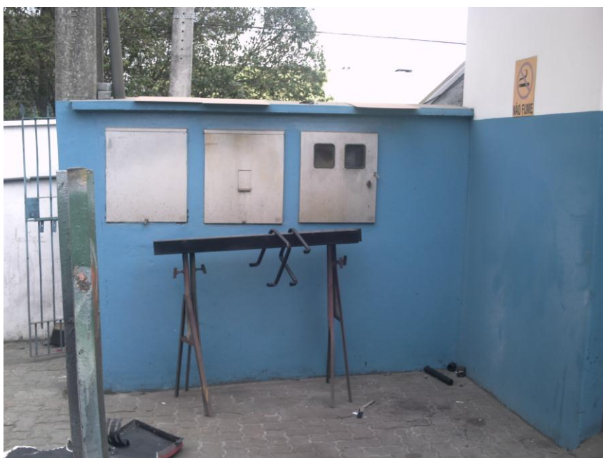
Figura 15 - Entrada de energia da empresa
