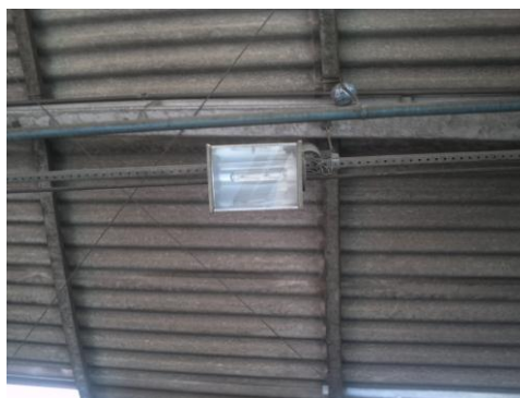
Figura 22 - Lâmpada de vapor de sódio 400 W
