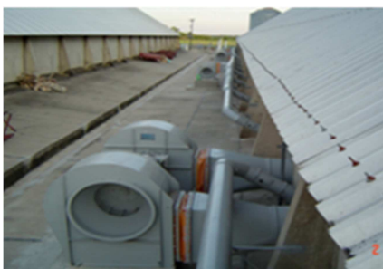
Figura 10 - Dutos de alimentação de ar Fonte: Silva (2008)
