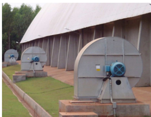
Figura 4 - Ventiladores de aeração Fonte: Aeroter (2012)
