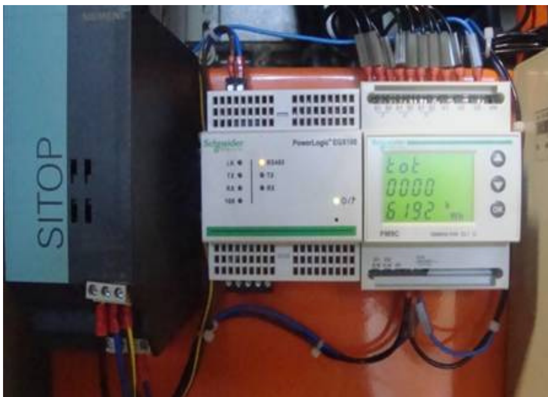
Figura 40: Monitoração do consumo de energia elétrica. Fonte: Autoria própria.
