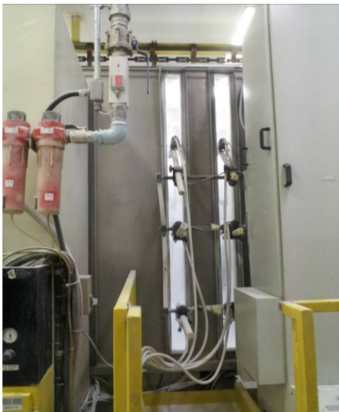
Figura 26: Medidor de vazão de ar comprimido da cabine de pintura. Fonte: Autoria própria.
