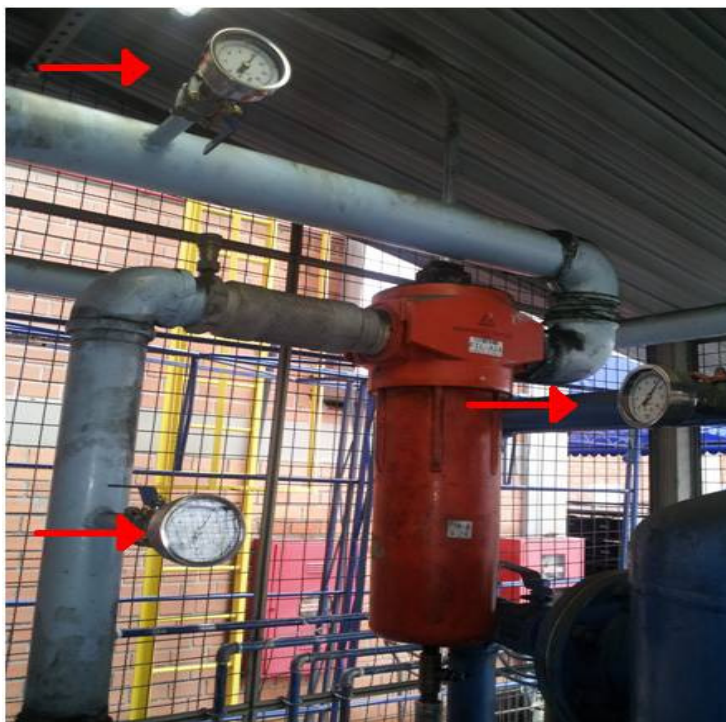
Figura 27: Medidor de pressão do ar comprimido da pintura. Fonte: Autoria própria.
