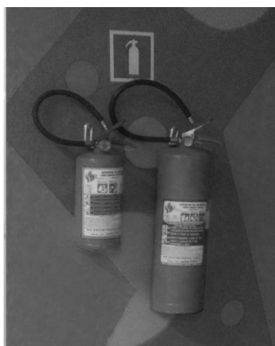
Figura 9: Extintores e sinalização de dispositivos de incêndio do pavimento 01 Fonte: a autora (2018).
