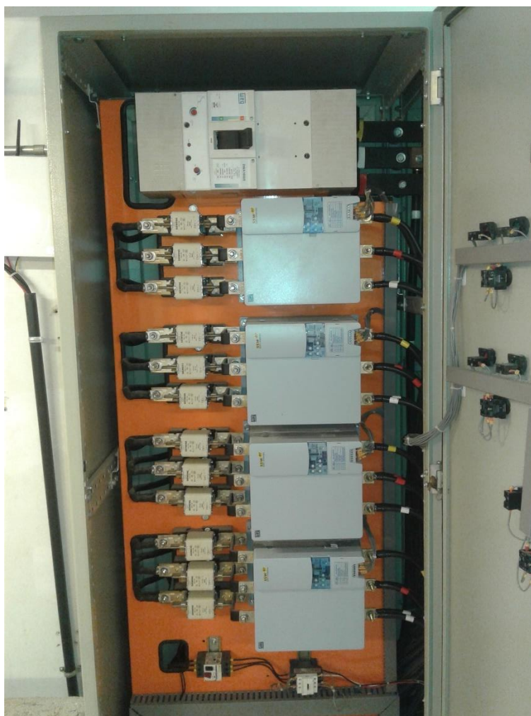
Figura 28: Painel elétrico - Empresa Alpha
