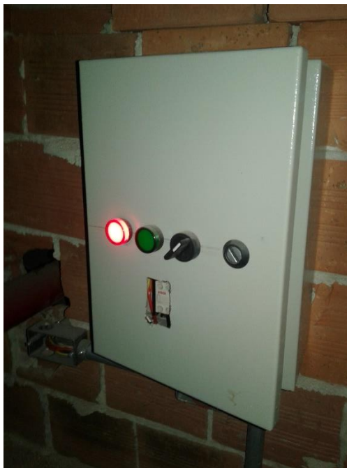
Figura 45: Porta do Painel Elétrico – Foxtrot
