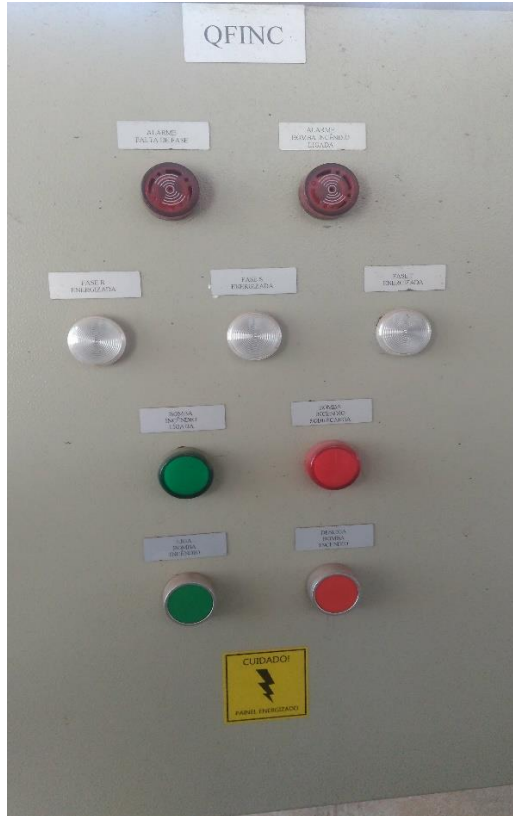
Figura 43: Porta do Painel Elétrico – Delta Fonte: O Autor (2018)
