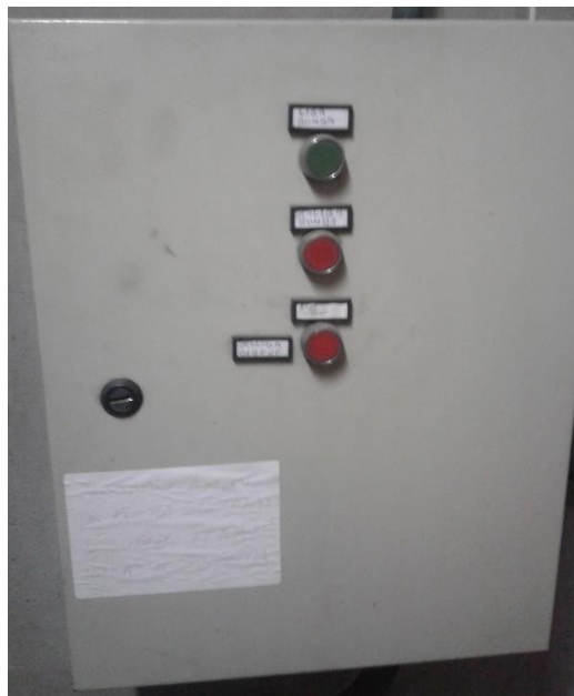
Figura 44: Porta do Painel Elétrico – Eco Fonte: O Autor (2018)
