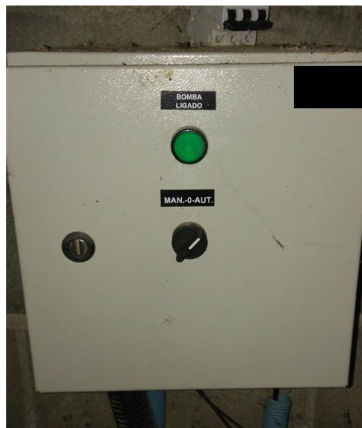
Figura 42: Porta do Painel Elétrico – Charlie Fonte: O Autor (2018)
