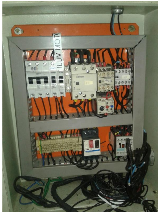
Figura 32: Pannel Elétrico - Empresa Eco
