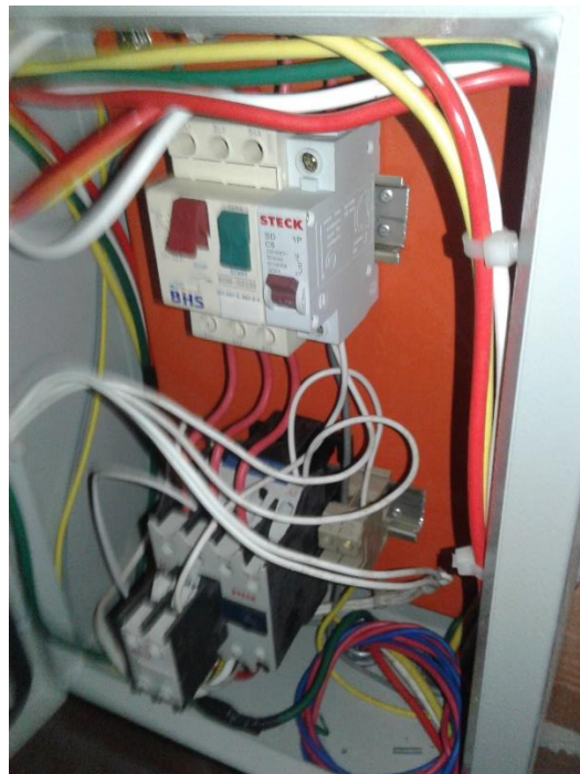
Figura 33: Pannel Elétrico - Empresa Foxtrot
