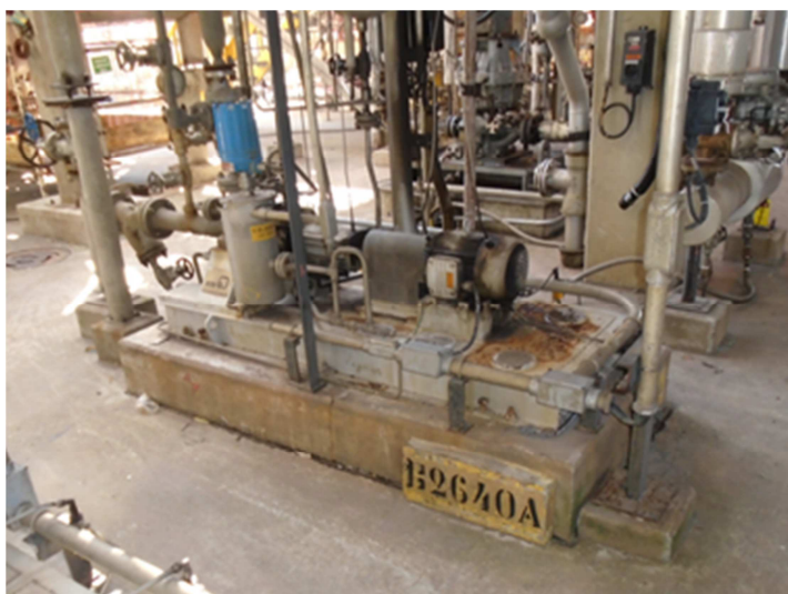
Figura 13 – Bomba industrial Fonte: O Autor, 2016.
