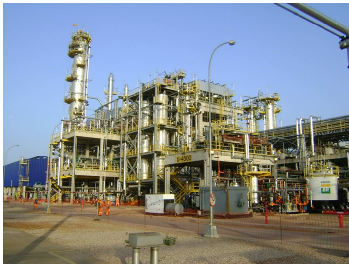
Figura 7 – Unidade de hidrodessulfurização de enxofre Fonte: O Autor, 2016.
