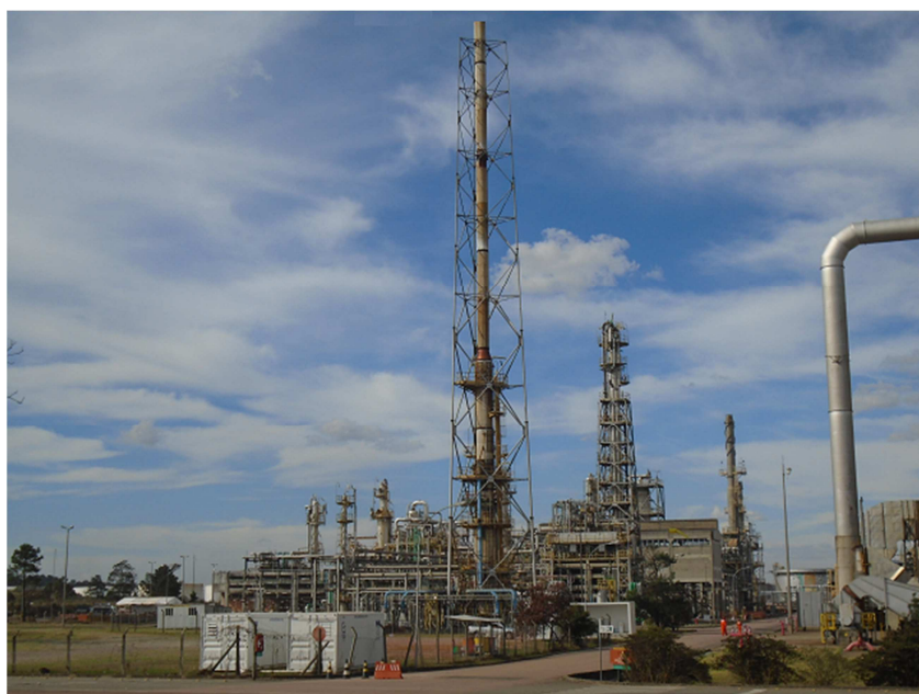
Figura 14 – Vista da unidade de remoção de H_2S Fonte: O Autor, 2016.
