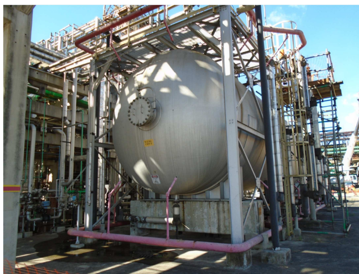
Figura 10 – Vaso de pressão Fonte: O Autor, 2016.
