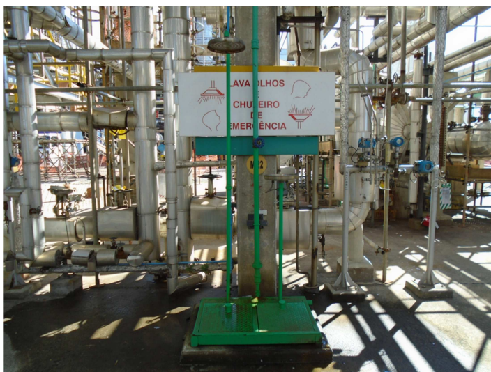
Figura 21 – Lava olhos e chuveiro de emergência Fonte: O Autor, 2016.
