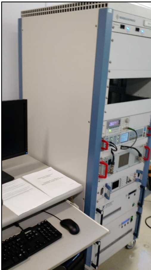
Figura 17 – Armário com Equipamentos auxiliares Fonte: O Autor, 2016.
