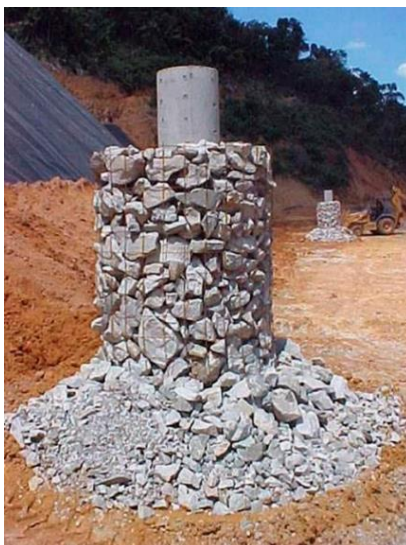
Figura 10 – Vista do sistema de drenagem de gases
