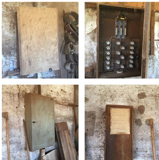
Figura 20 – Quadros de energia sem sinalização.
