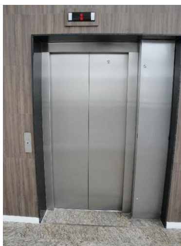
Figura 7 - Vista da porta do pavimento e presença do maquinário em anexo Fonte: autor, 2017.
