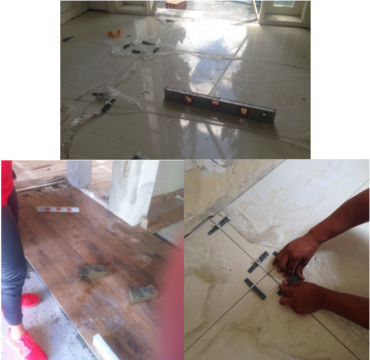
Figura 10 – Utilização do nível de bolha, cliques e cunha para verificação do nivelamento do piso.
