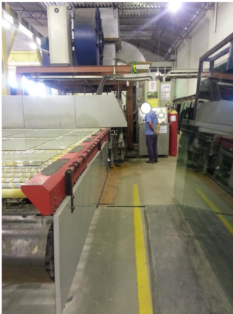
Figura 3 – Ponto 2 - Painel de Controle Fonte: O Autor, 2014.
