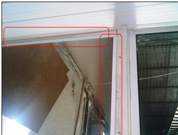
Imagem 20 – Vedação dos Vidros Fonte: O Autor (2013)
