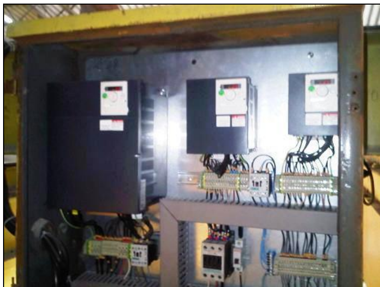
Imagem 18 – Fiação dos Motores da Ponte Rolante Fonte: O Autor (2013)
