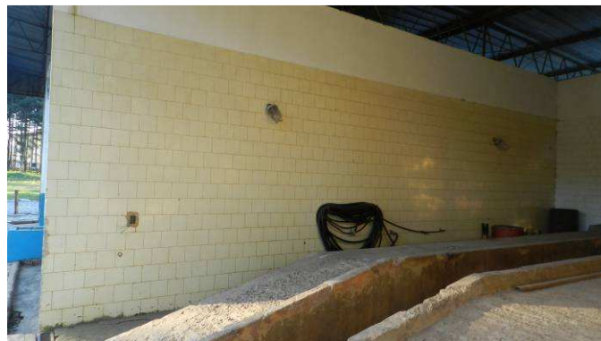
Figura 45 – Interruptor retirado e não reinstalado Fonte: O Autor, 2013
