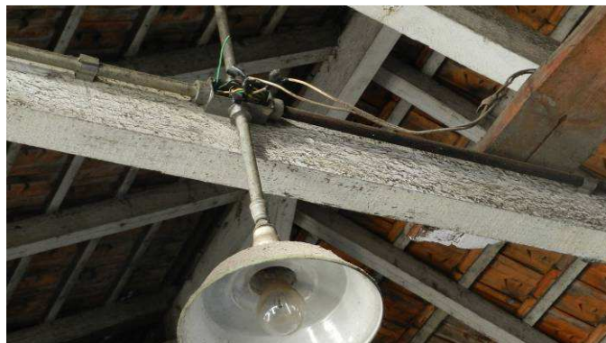
Figura 27 – Fiação exposta Fonte: O Autor, 2013
