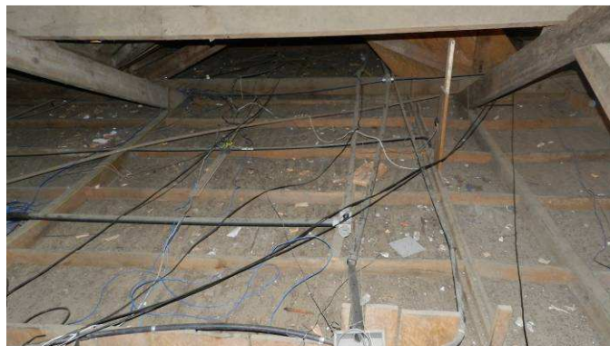
Figura 37 – Tubulações quebradas sobre o forro Fonte: O Autor, 2013
