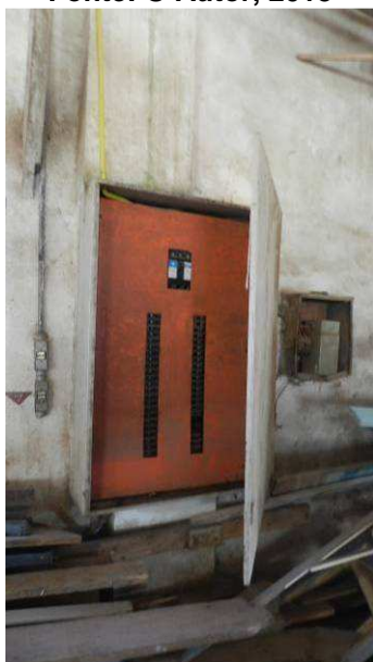
Figura 32 – Quadro sem identificação dos circuitos Fonte: O Autor, 2013
