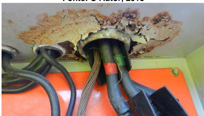
Figura 8 – Quadro em adiantado estado de corrosão Fonte: O Autor, 2013
