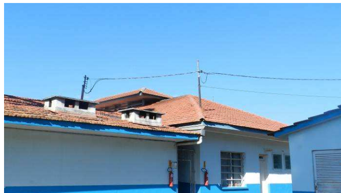
Figura 23 – Mais de uma entrada de energia no pavilhão rancho Fonte: O Autor, 2013
