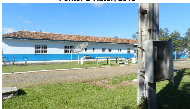
Figura 9 – Aterramento em más condições de conservação. Fonte: O Autor, 2013
