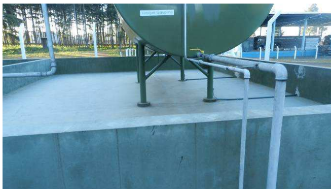
Figura 42 – Aterramento existente nos tanques Fonte: O Autor, 2013
