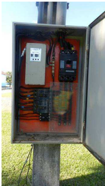
Figura 6 – Quadro de proteção geral de baixa tensão do Rancho Fonte: O Autor, 2013
