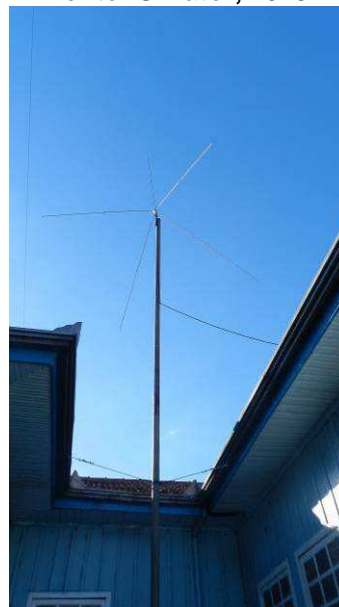
Figura 41 – Antena funciona como único pára-raios da edificação Fonte: O Autor, 2013
