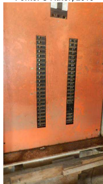
Figura 33 – Sinais de manutenção precária Fonte: O Autor, 2013
