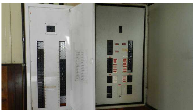
Figura 34 – Quadro de distribuição geral Fonte: O Autor, 2013
