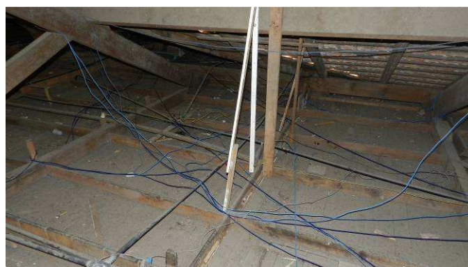
Figura 35 – Fiação elétrica e cabeamento de rede soltos sobre o forro Fonte: O Autor, 2013
