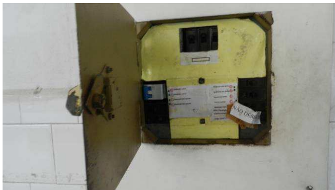
Figura 22 – Quadros em situação precária e fora de norma Fonte: O Autor, 2013
