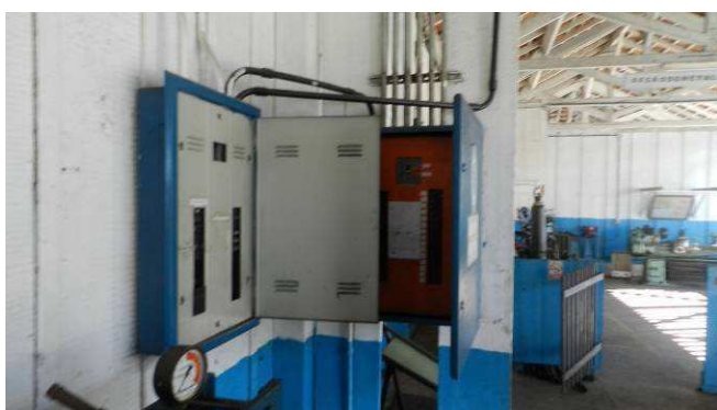
Figura 24 – Painéis e infra estrutura da oficina mecânica Fonte: O Autor, 2013
