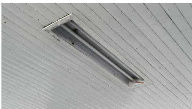
Figura 14 – Iluminação obsoleta e queimada no pavilhão do rancho. Fonte: O Autor, 2013
