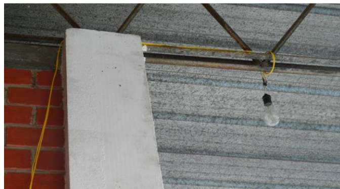
Figura 47 – Fiação exposta e lâmpada inadequada em área classificada (abastecimento) Fonte: O Autor, 2013
