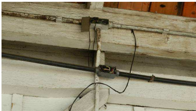
Figura 26 – Fiação exposta Fonte: O Autor, 2013
