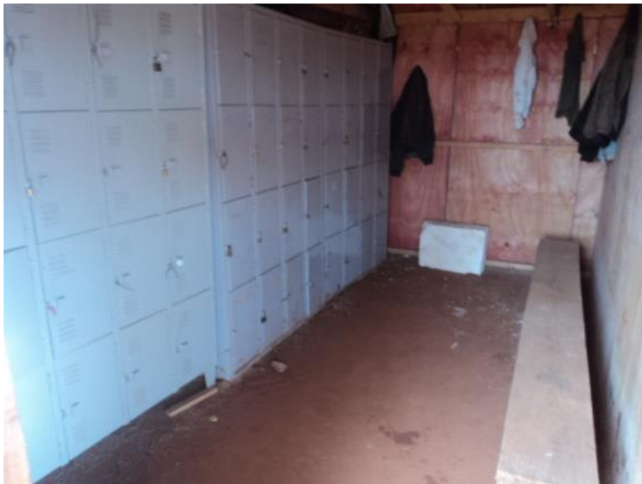
Figura 16: Vestiário da Obra C sem ventilação correspondente a 1/10 de área de piso.
