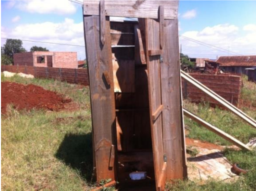
Figura 13: Instalação Sanitária da Obra E sem tratamento de esgoto. Fonte: O autor (2012).
