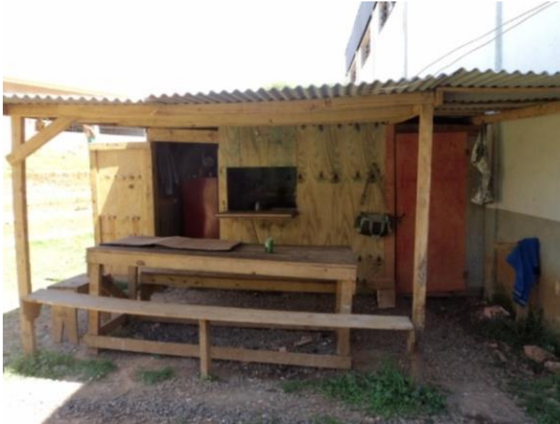
Figura 21: Local de refeições da Obra B sem paredes que permitam o isolamento durante as refeições e piso inadequado. Fonte: O autor (2012).
