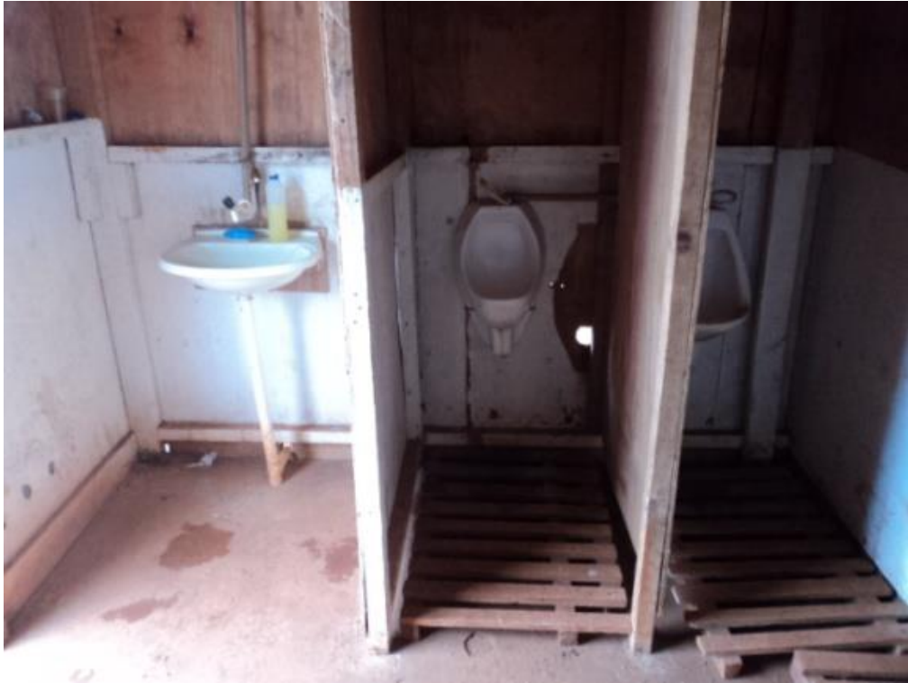
Figura 11: Desprovimento de recipiente para coleta de papéis usados, revestimento interno de material impermeável no lavatório e mictórios sem descarga provocada na Obra C.
