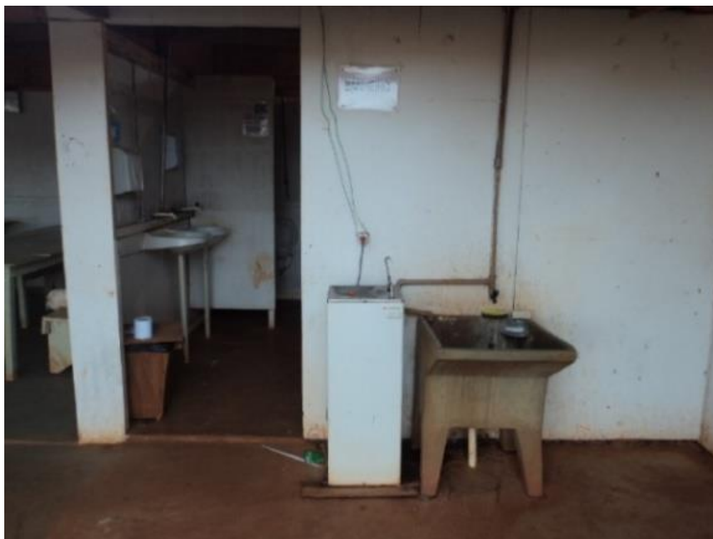
Figura 26: Lavanderia da Obra C com número inadequado de tanque. Fonte: O autor (2012).
