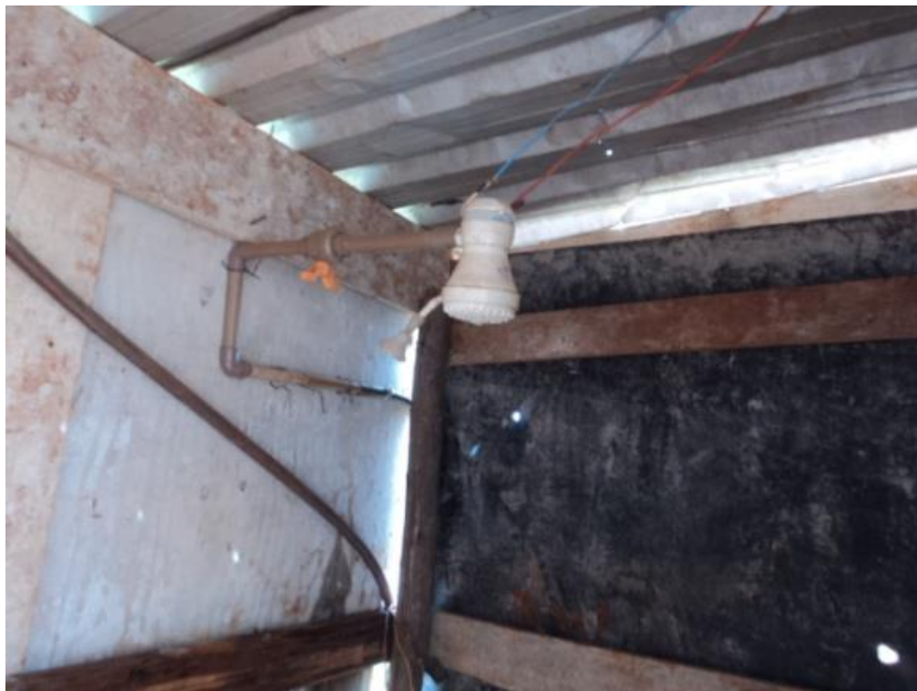
Figura 12: Chuveiro sem suporte para sabonete e cabide para toalha na Obra D. Fonte: O autor (2012).
