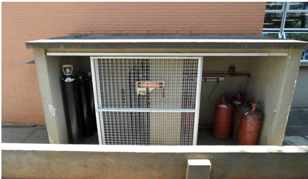
Figura 3 – Local de armazenagem dos gases comprimidos
