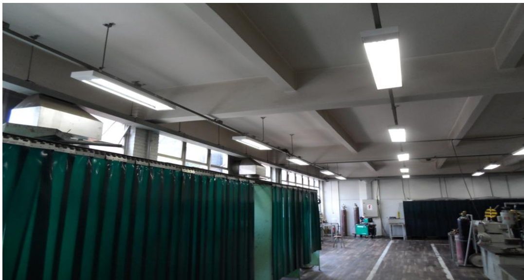
Figura 2- Sistema de iluminação do laboratório de soldagem
