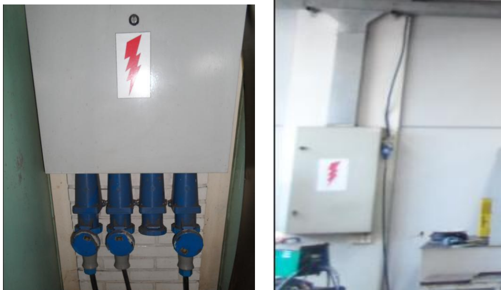
Figura 11 – Quadros de energia e instalações elétricas
