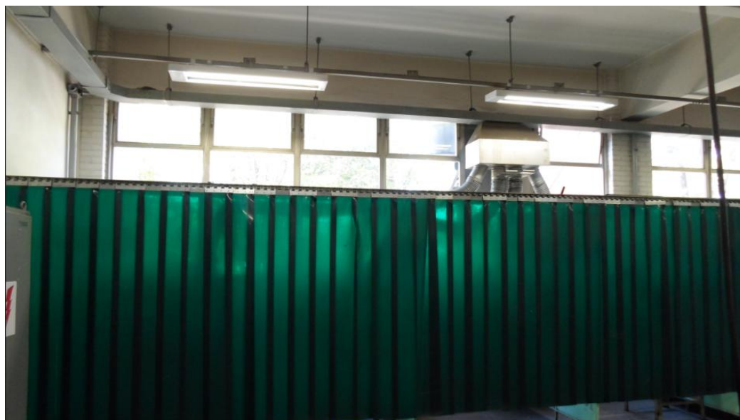
Figura 4 – Cabines de soldagem com sistema de exaustão
