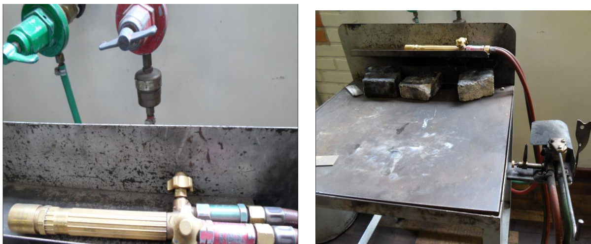
Figura 12- Válvulas de proteção e mangueiras
