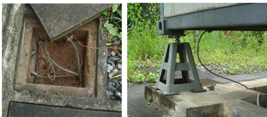
Figura 18 – Sistema de Aterramento de Entrada e Aterramento do container . Fonte: Própria.
