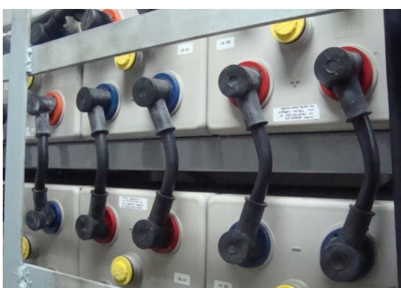
Figura 23 – Restrição de Acesso - bornes das baterias protegidos. Fonte: Própria.
