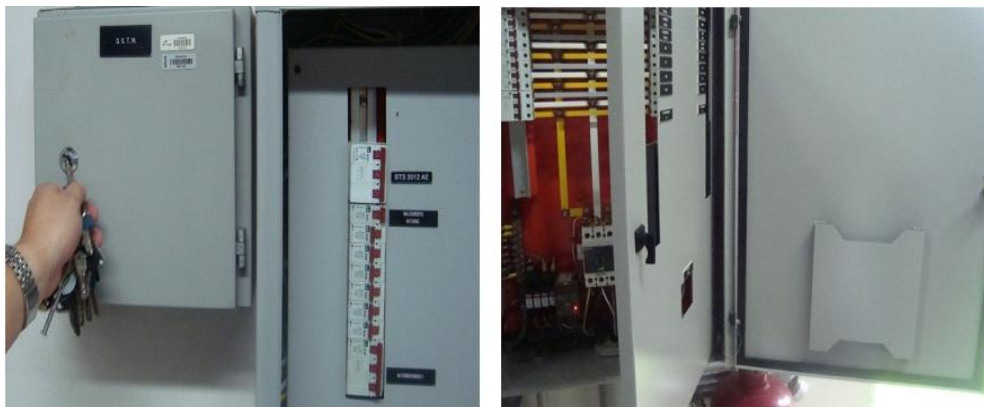
Figura 24 – Restrição de Acesso aos Circuitos energizados do QDG inadequados. Fonte: Própria.
