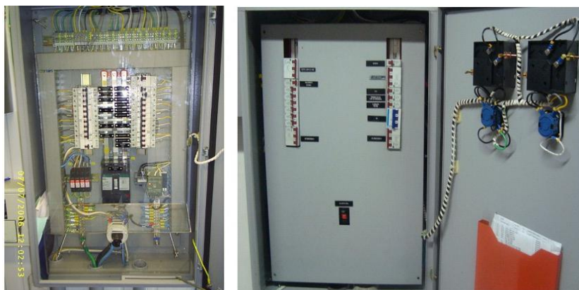
Figura 21 – Restrição de Acesso aos Circuitos energizados do QDG adequados. Fonte: Própria.
