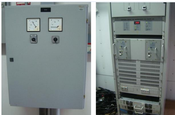
Figura 27 – Identificação de Circuitos Elétricos. Fonte: Própria.
