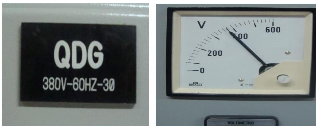
Figura 22 – Restrição de Acesso – Informação de Quadro Energizado. Fonte: Própria.
