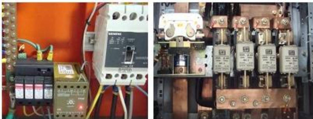
Figura 20 – Dispositivos de Proteção. Fonte: Própria.
