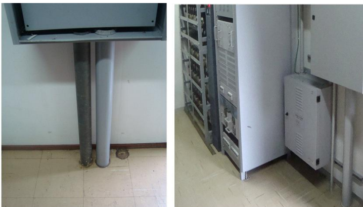
Figura 28 – Sinalização ausente. Fonte: Própria.
