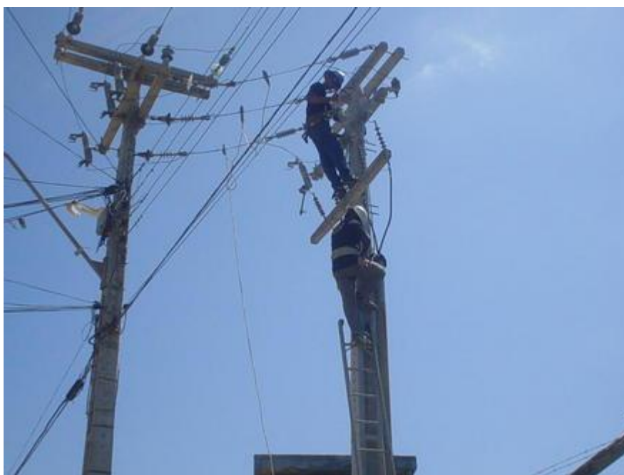
Figura 7: Combinação de trabalho em altura e serviço com eletricidade
