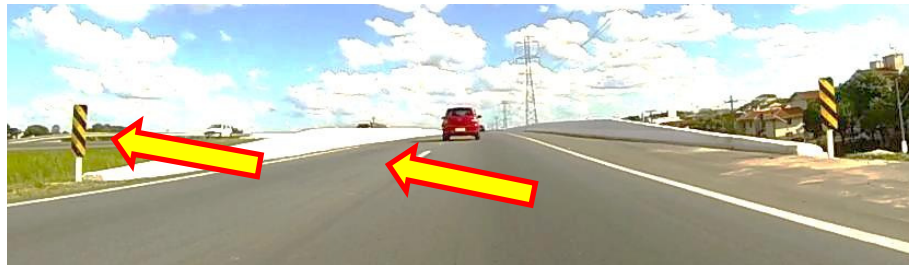
Figura29– Balizamento de ponte incorreto Fonte: o autor.
