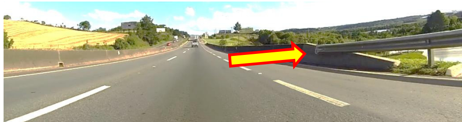
Figura 22– Transição incorreta entre elementos distintos de contenção em rodovia pedagiada Fonte: o autor.
