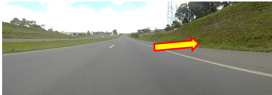
Figura15– Falta de zona livre lateral e talude de corte sem dispositivo de contenção Fonte: o autor.
