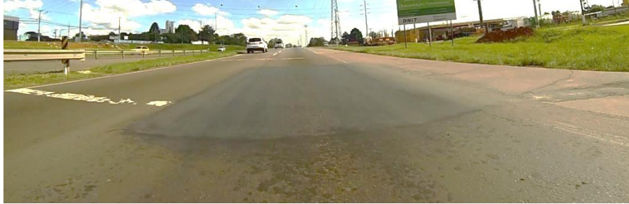
Figura9– Asfalto refeito sem sinalização horizontal Fonte: o autor.
