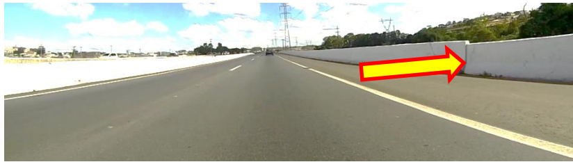
Figura19– Descontinuidade em barreira de concreto na rodovia não pedagiada Fonte: o autor.
