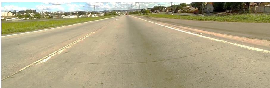
Figura11– Sinalização horizontal aplicada de forma incorreta em pavimento tipo cimento Fonte: o autor.
