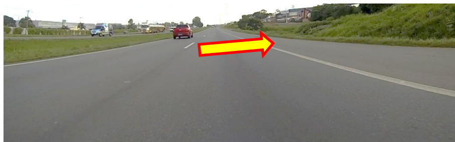
Figura 13– Falta de zona livre lateral Fonte: o autor.
