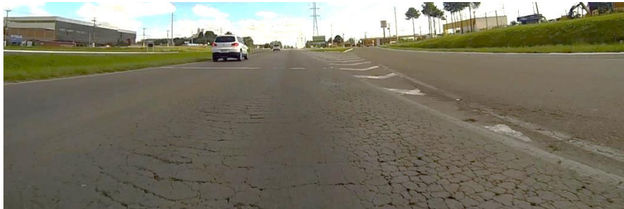
Figura10– Sinalização horizontal de marcas de canalização apagadas Fonte: o autor.
