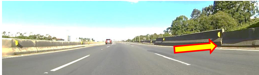
Figura20– Descontinuidade de barreira de concreto em rodovia pedagiada Fonte: o autor.
