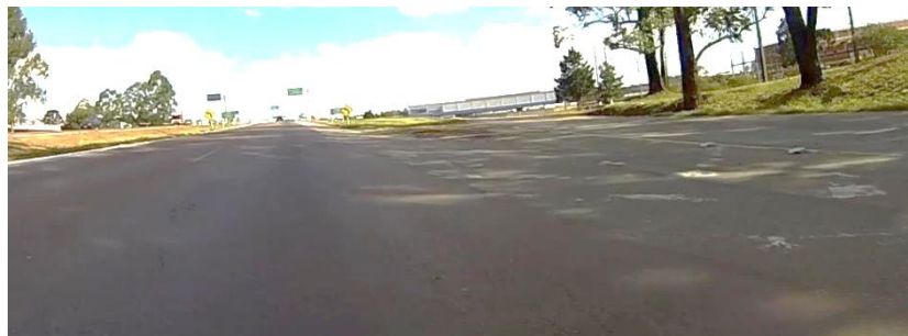
Figura34– Falta de marcador de perigo, marcas de canalização, linha de bordo e tachões Fonte: o autor.
