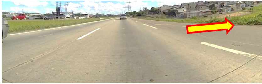
Figura14– Falta de zona livre lateral e talude de aterro sem proteção Fonte: o autor.
