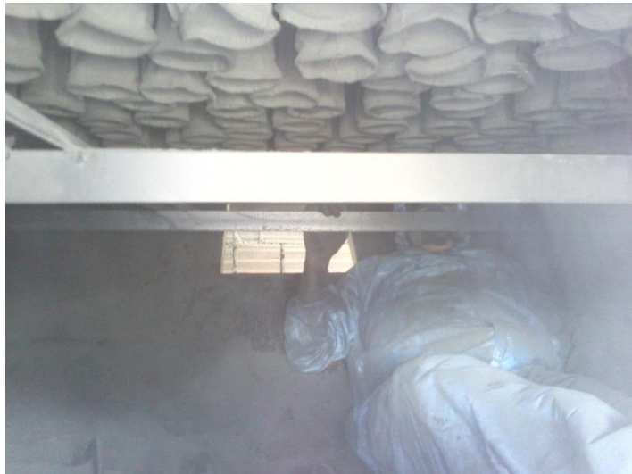
Figura 66 – Funcionário no interior da Câmara dos Filtros de Manga Fonte: A autora (2013)
