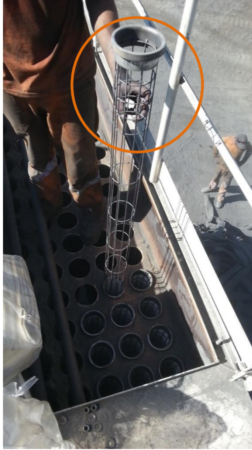
Figura 61 – Gaiola do Filtro de Manga – Falta de EPI Fonte: A autora (2014)
