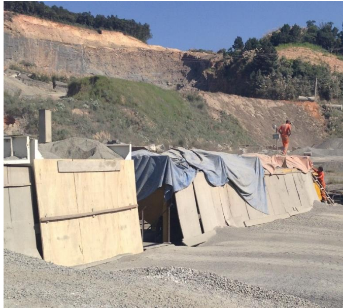
Figura 35 – Risco de Queda Fonte: A autora (2014)
