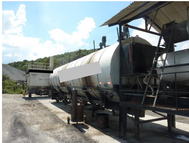
Figura 38 – Tanque de Armazenamento
