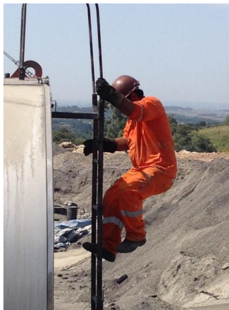
Figura 42 – Risco de queda em altura
