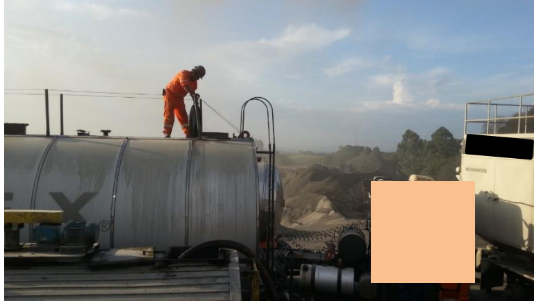
Figura 41 – Risco de queda de altura
