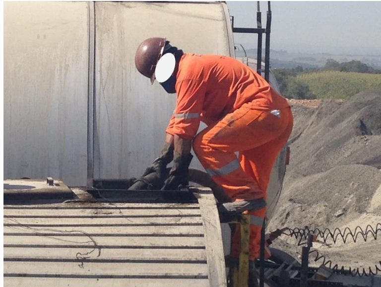
Figura 46 – Risco de queda, queimadura, ergonomia, gases e vapores orgânicos.
