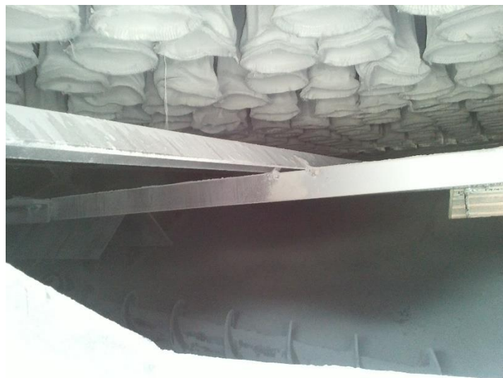
Figura 64 – Parte interna da Câmara dos Filtros de Manga Fonte: A autora (2013)
