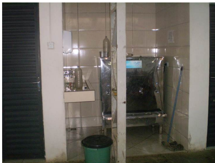
Figura 10 – Lavatório. Fonte: A autora (2014).
