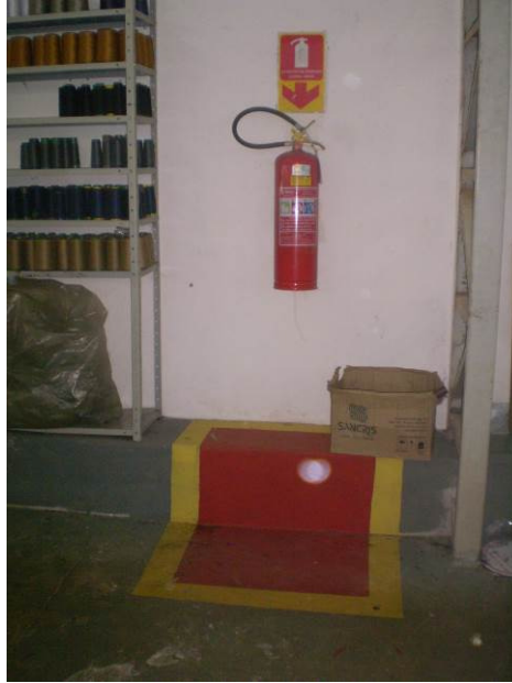
Figura 12 – Extintores. Fonte: A autora (2014).
