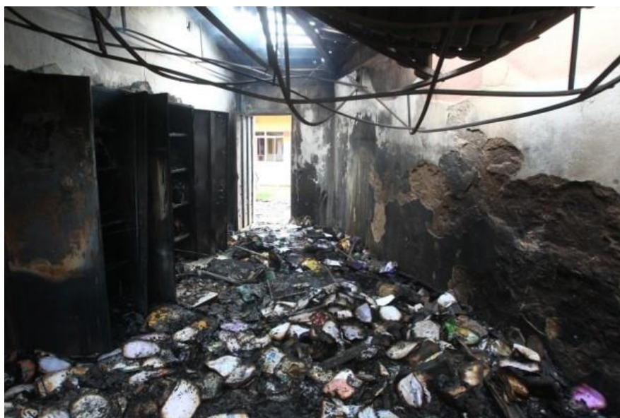
Figura 7 – Destruição causada por incêndio em escola municipal em Goiás. Fonte: G1 (2014) a .
