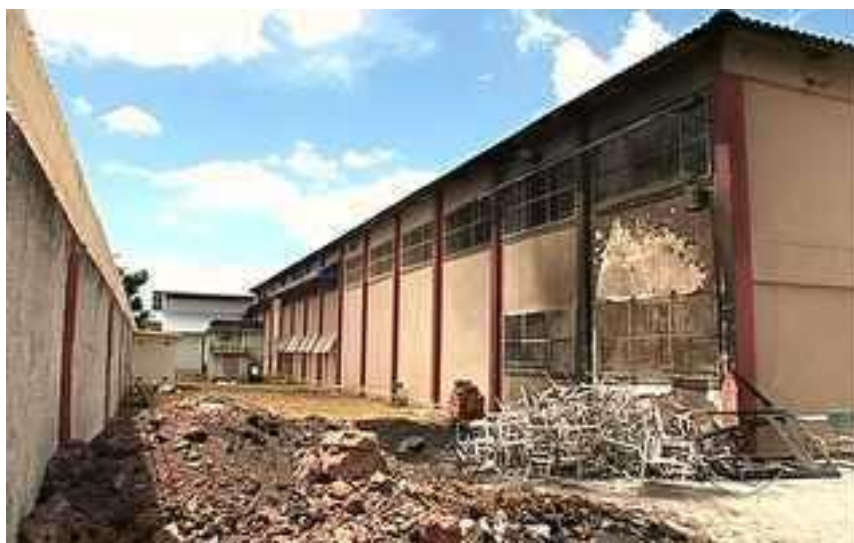
Figura 3 – Incêndio em escola de Serra/ES em 2013. Fonte: G1 (2013) a .
