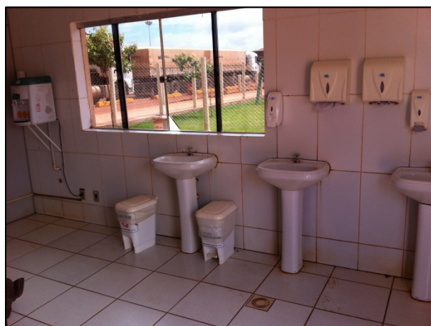
FIGURA 26: PURIFICADOR, PIAS, TOALHAS DO REFEITÓRIO.
